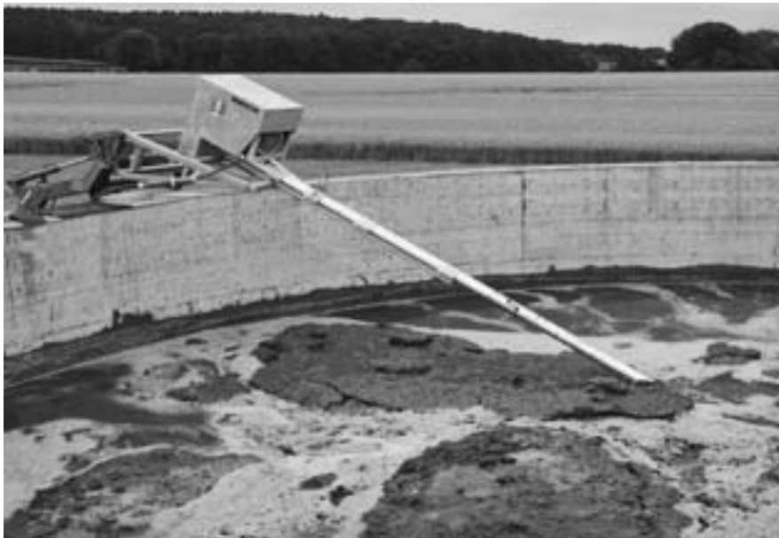
Σχήμα 1.5. Αναδευτήρας διαλύει την επιφανειακή κρούστα σε δεξαμενή λυμάτων
