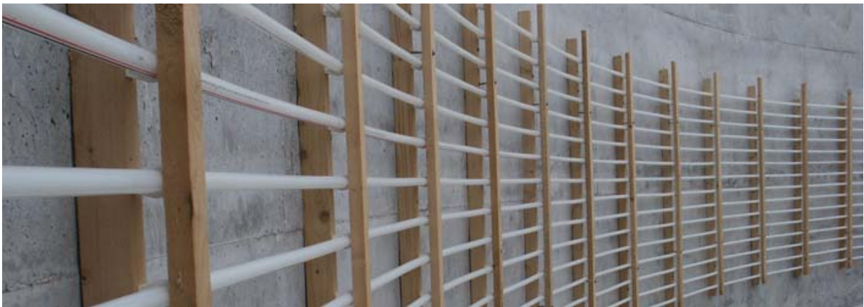
Σχήμα 3.15. Σωλήνες θέρμανσης υποστρώματος στο τοιχίο του βιοαντιδραστήρα
