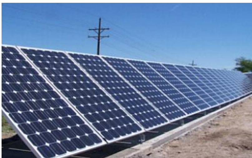
Σχήμα 1.7 - Φωτοβολταϊκό πάρκο 100 kW στην Ηλεία
