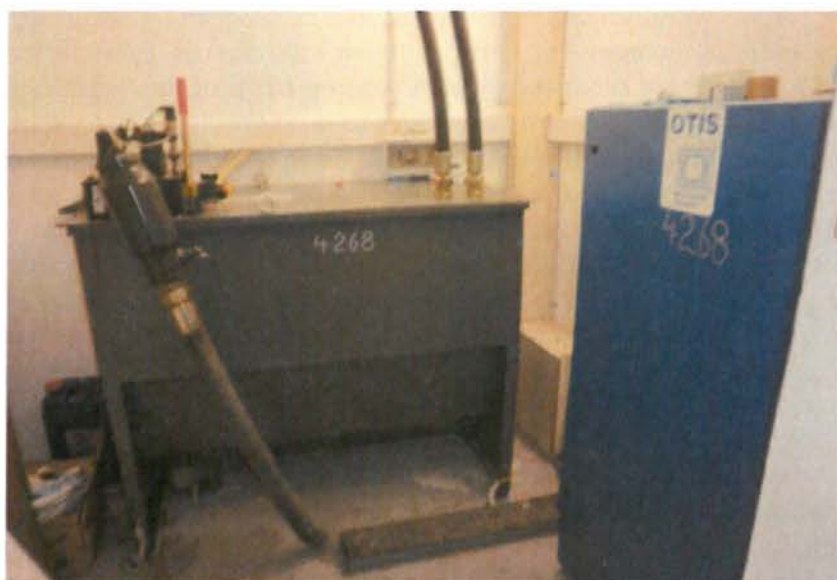
Εικόνα 3.3 Μηχανοστάσιο υδραυλικού ανελκυστήρα χειρουργείου
