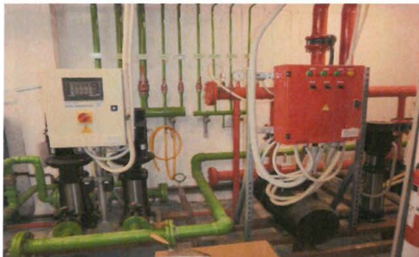
Εικόνα 3.2 Πιεστικό ύδρευσης – αντλίες πυρόσβεσης
