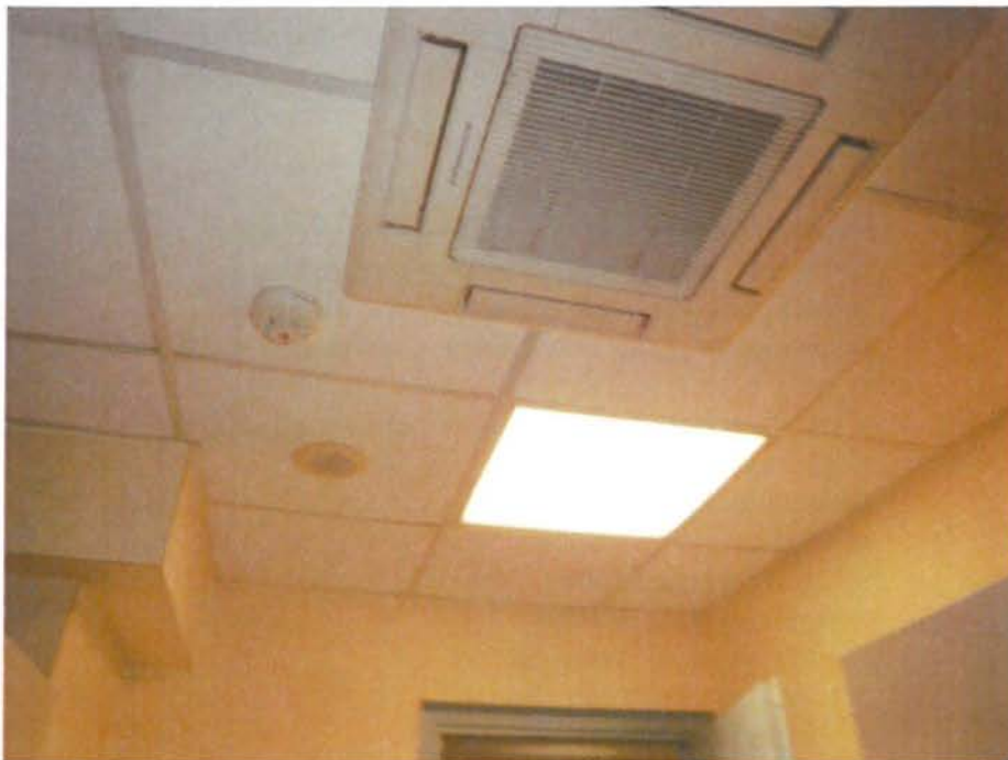
Εικόνα 3.15 Κλιματισμός, πυρανίχνευση, μεγάφωνα
