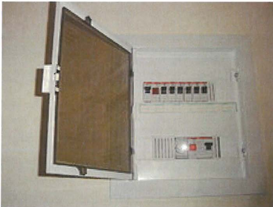
Εικόνα 2.2 Πίνακας διανομής σε ηλεκτρική εγκατάσταση
