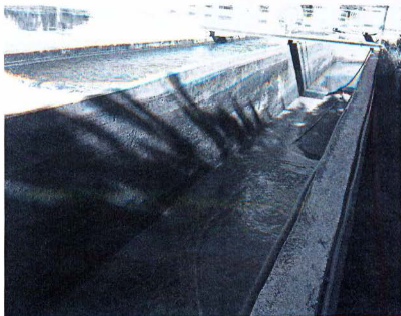
Σχήμα 3.2: ΚΑΝΑΛΙ ΥΠΕΡΧΕΙΛΗΣΗΣ ΑΚΑΘΑΡΤΩΝ ΥΔΑΤΩΝ (ΠΡΙΝ ΤΗΝ ΕΙΣΟΔΟ ΣΤΙΣ ΔΕΞΑΜΕΝΕΣ ΚΡΟΚΙΑΩΣΗΣ.)
