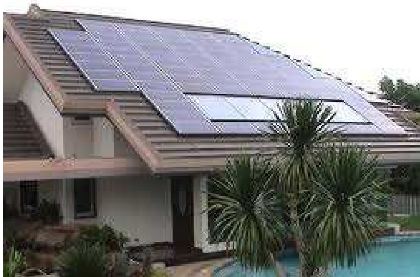
Εικόνα 7.1 φωτοβολταϊκά πάνελ σε στέγη κατοικίας
