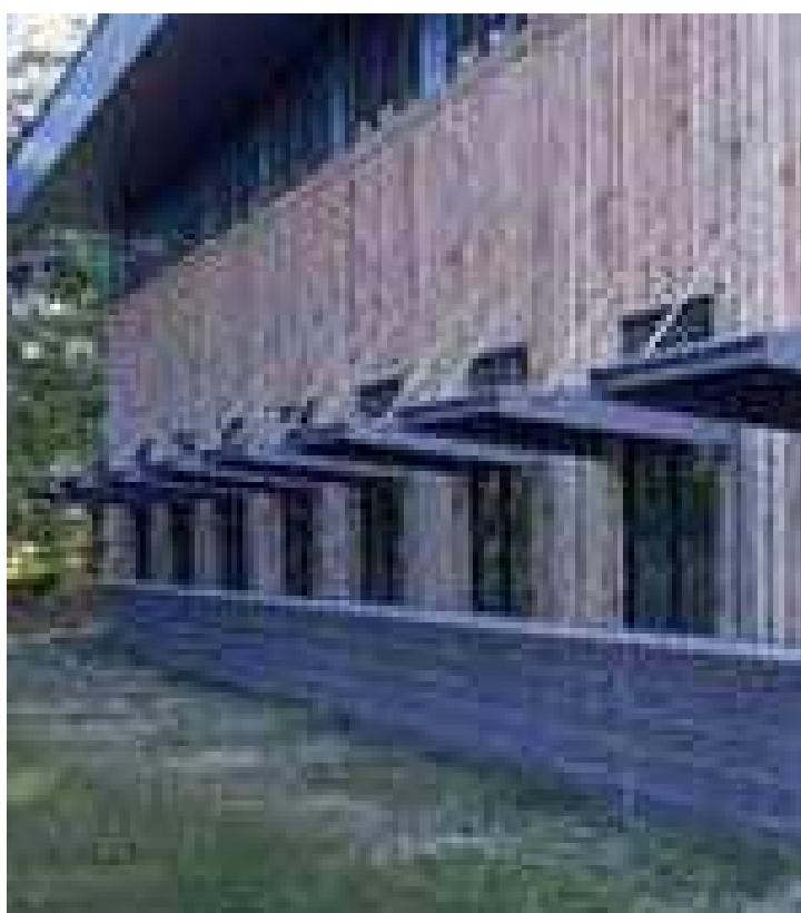
Εικόνα 6.9 Εξωτερικά ράφια φωτισμού
