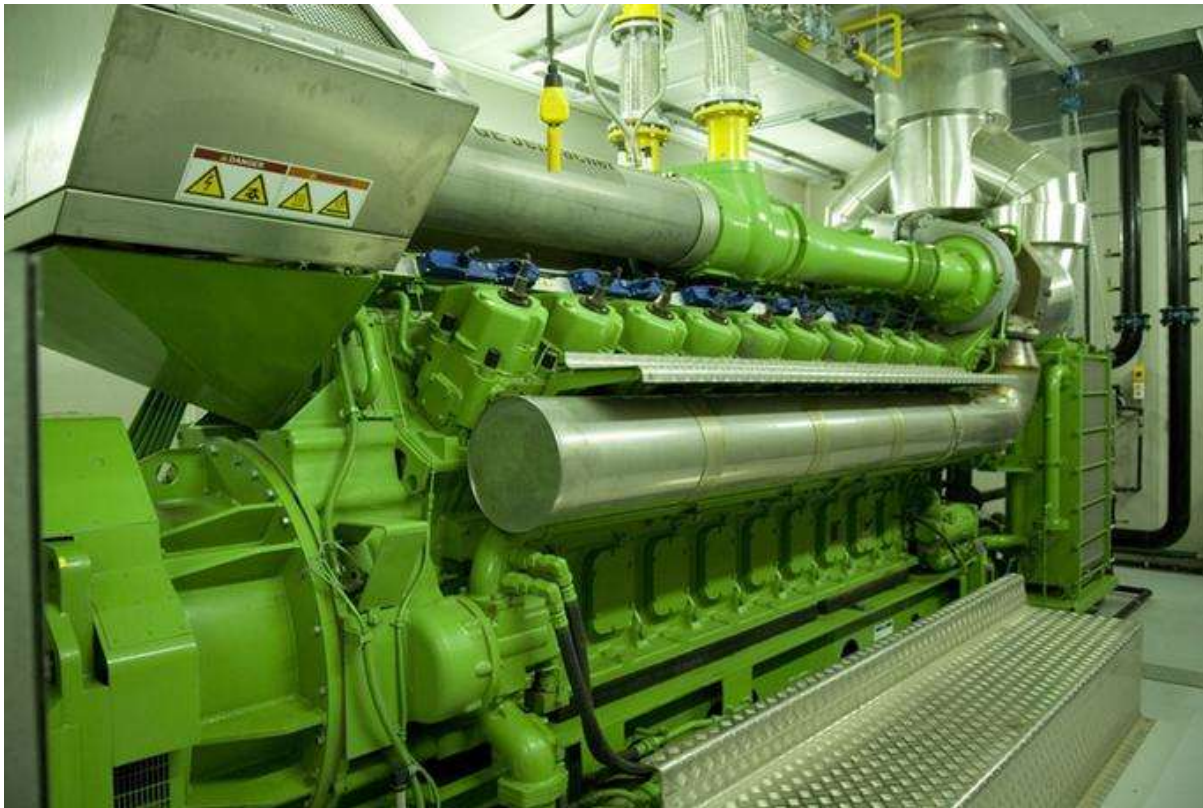
Αξιοποίηση βιοαερίου από ΧΥΤΑ στην περιοχή των Ανω Λιοσίων
