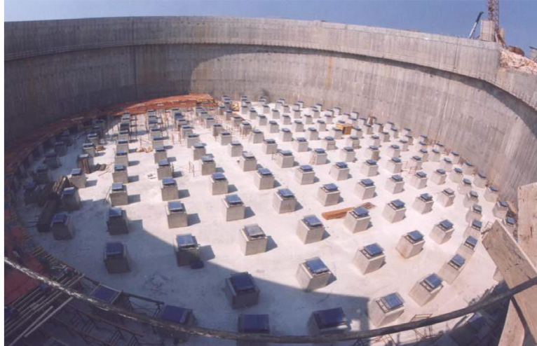
Εικόνα 1.9 Δεξαμενές φυσικού αερίου LNG στην Νήσο Ρεβυθούσα [13]
