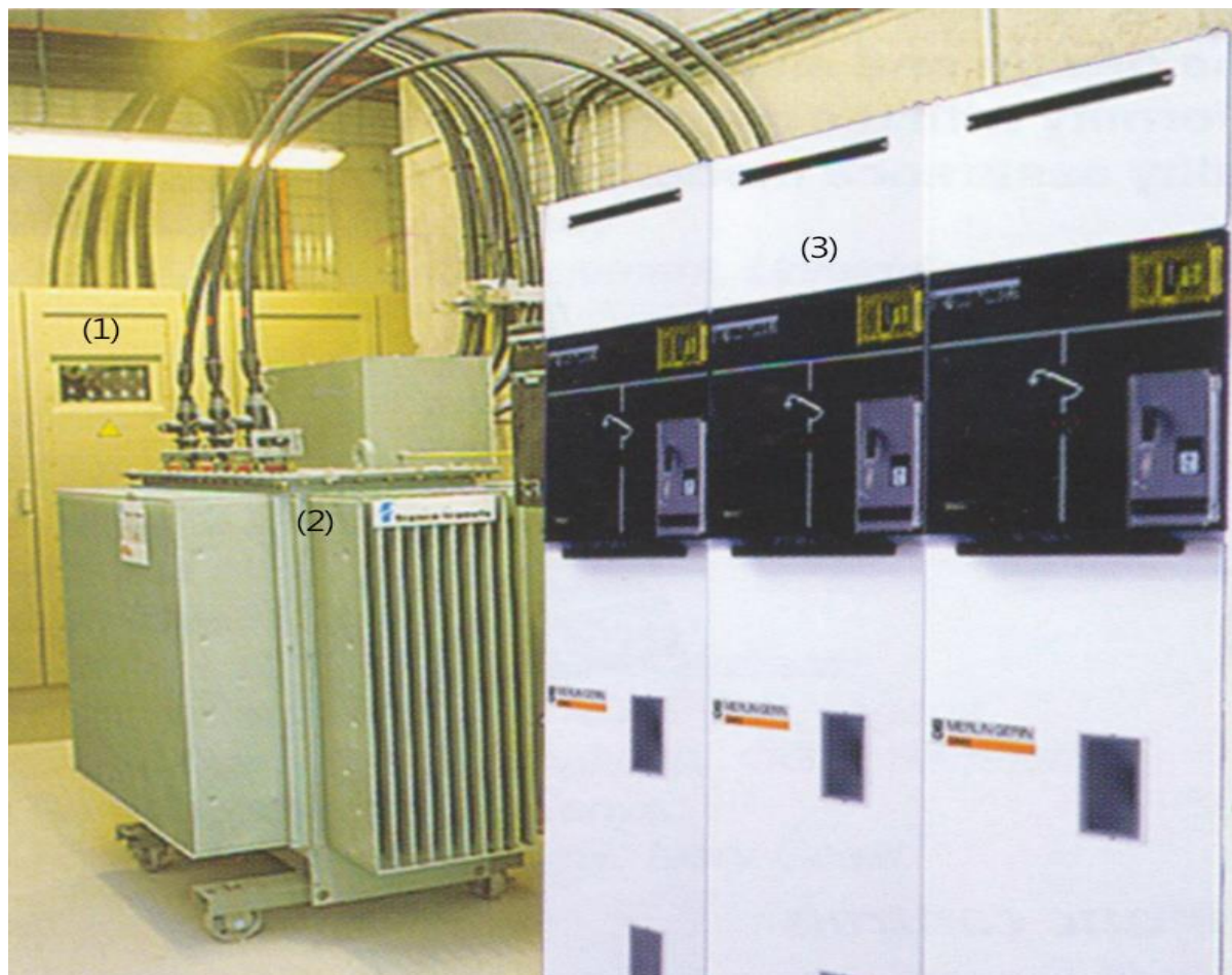
Σχήμα 44: Υποσταθμός μέσης τάσης, (1) Πίνακας μέσης τάσης, (2) Μ/Σ ισχύος, (3) Γενικός Πίνακας διανομής χαμηλής τάσης
