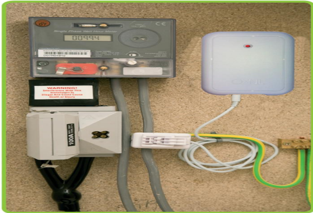
Ολοκληρωμένη εγκατάσταση έξυπνου μετρητή
