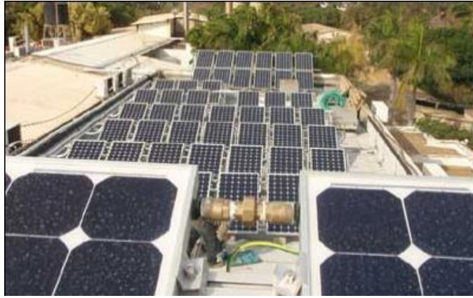
Εικόνα 8: Η αποδοτικότητα ενός θερμικού φωτοβολταϊκού σταθμού είναι 10 έως 30% μεγαλύτερη σε σύγκριση με ένα απλό φωτοβολταϊκό σταθμό
