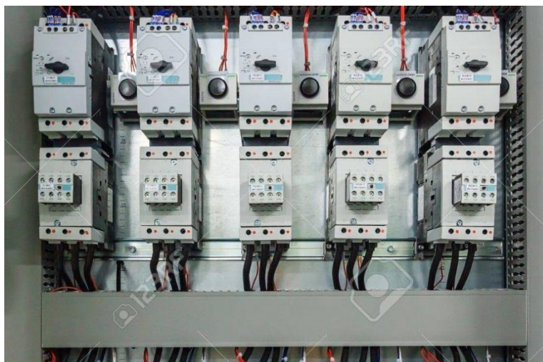
Εικόνα 24. Αυτοματισμοί με έλεγχο PLC σε βιομηχανία
