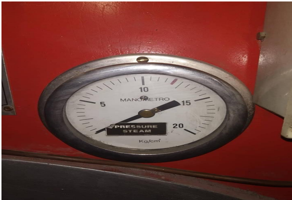
Εικόνα 33: Μανόμετρο εξόδου ατμολέβητα
