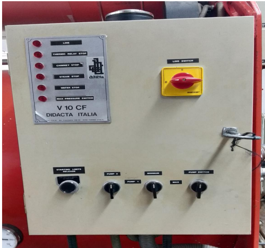
Εικόνα 46 : Πίνακας ελέγχου εγκατάστασης
