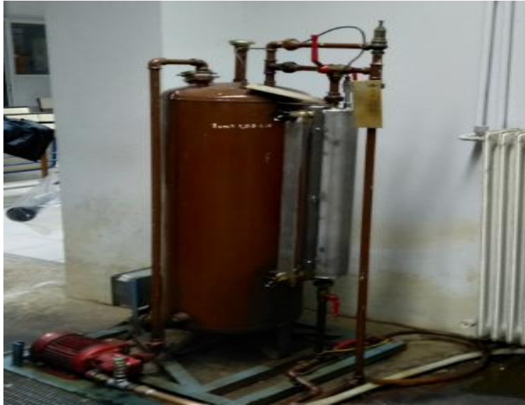
Εικόνα 14: Δεξαμενή ημερήσιας κατανάλωσης
