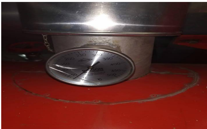
Εικόνα 31:Θερμόμετρο εξόδου καυσαερίων
