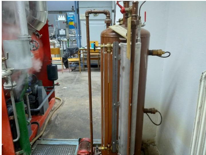
Εικόνα 38: Υαλοδείκτης δεξαμενής ημερήσιας κατανάλωσης
