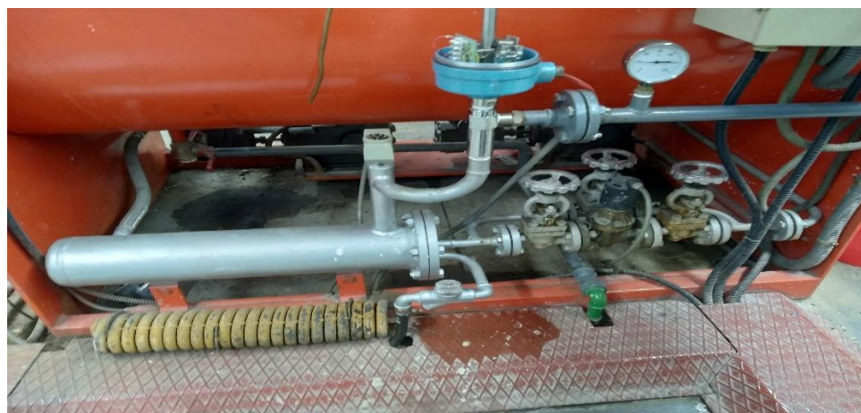
Εικόνα 5: Ο προθερμαντήρας τροφοδοτικού νερού.
