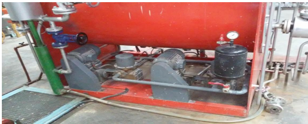
Εικόνα 4: Οι τροφοδοτικές αντλίες νερού με τους ηλεκτροκινητήρες τους και τον αεροκώδωνα στην έξοδό τους.
