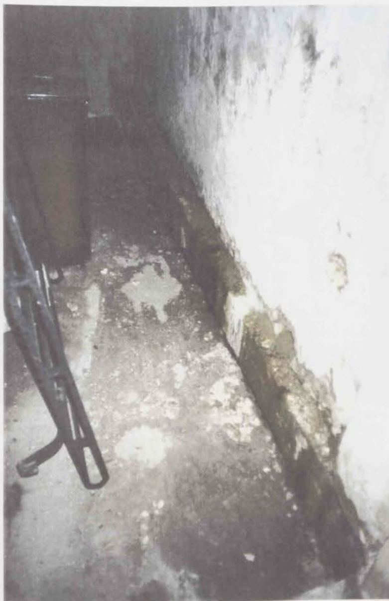
Εικόνα 6 : Το δάπεδο Υπογείου έχει υποχωρήσει. Διακρίνεται το σενάζ
