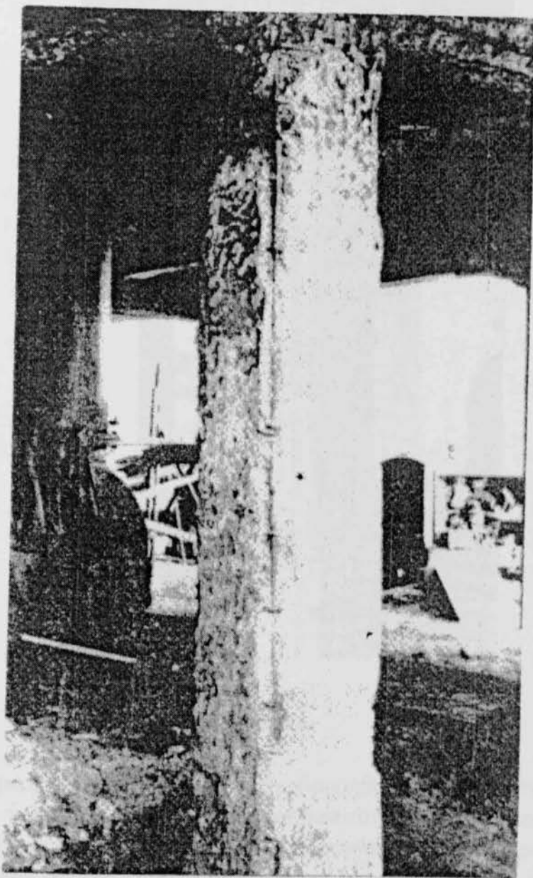
Σχ.4.2. Υποστύλωμα που χρειάζεται ενίσχυση
