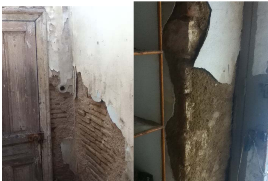
Εικόνα 6 Στο εσωτερικό της κατασκευής καταγράφηκαν διαγώνιες ρωγμές που ερμηνεύονται ως αστοχία λόγω διατμητικών τάσεων
