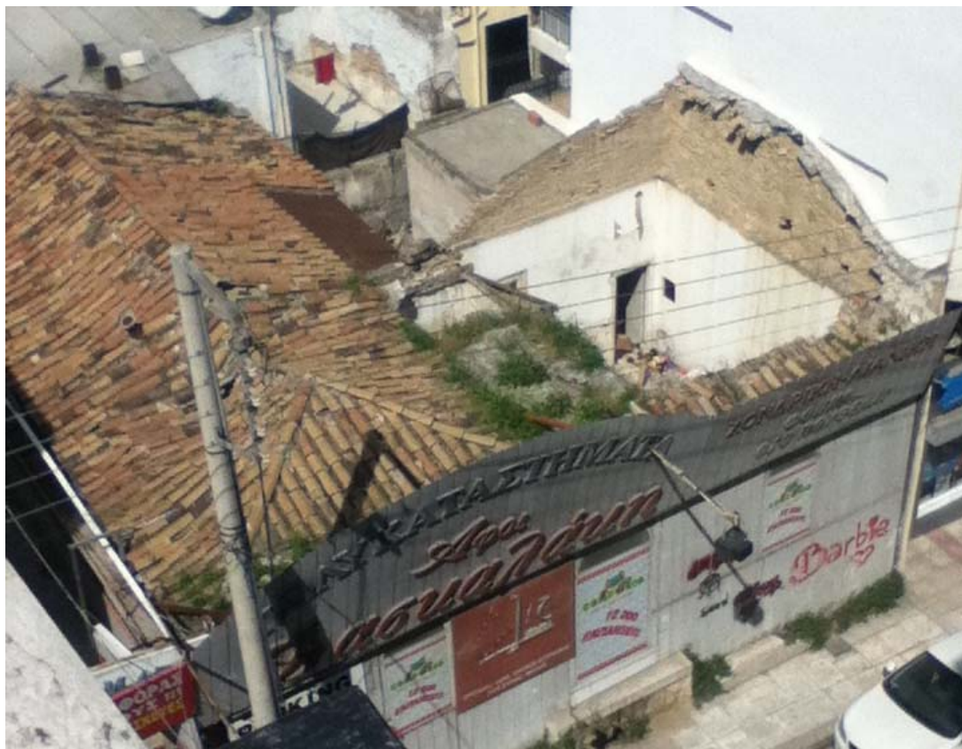
Εικόνα 5 Τμήμα της στέγης έχει καταρρεύσει λόγω παλαιότητας και έλλειψης συντήρησης
