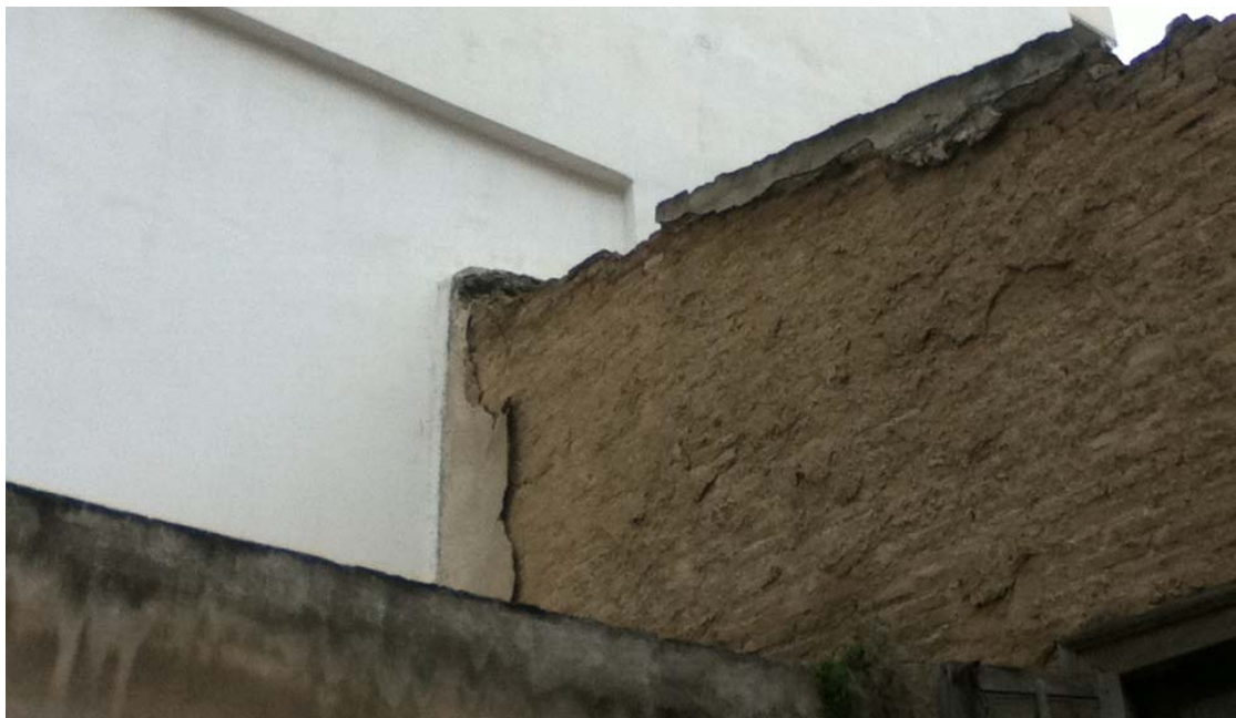
Εικόνα 8 Στο μεγαλύτερο μέρος της εξωτερικής τοιχοποιίας η επικάλυψη έχει αποκολληθεί
