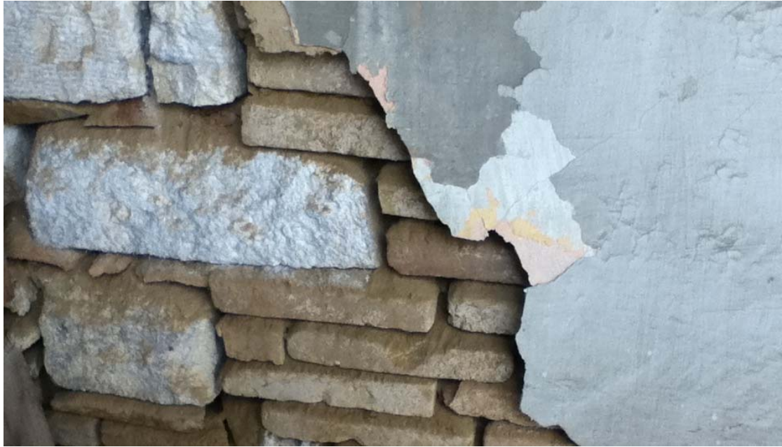
Εικόνα 7 Λεπτομέρεια της εσωτερικής τοιχοποιίας του κτιρίου (οπτοπλινθοδομή), με μερικώς αποκολλημένη επικάλυψη
