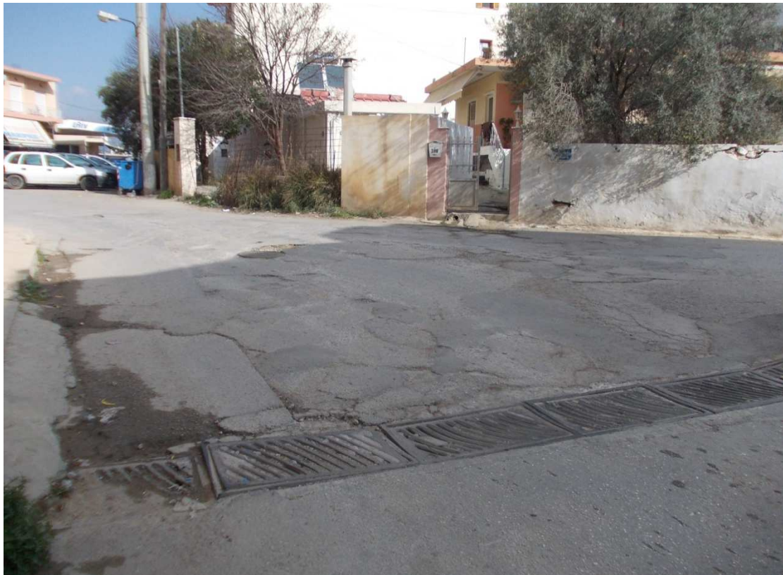
Εικόνα 49 Έντονες φθορές στο οδόστρωμα, σε μία διασταύρωση στα Μέγαρα
