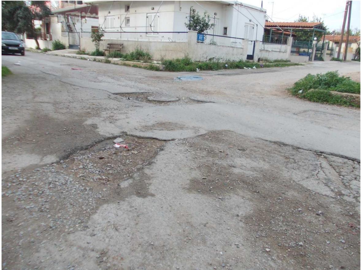
Εικόνα 38 Διασταύρωση στην Μάνδρα. Αρκετές ελλείψεις και φθορές Δίκτυο Πεζοδρόμων
