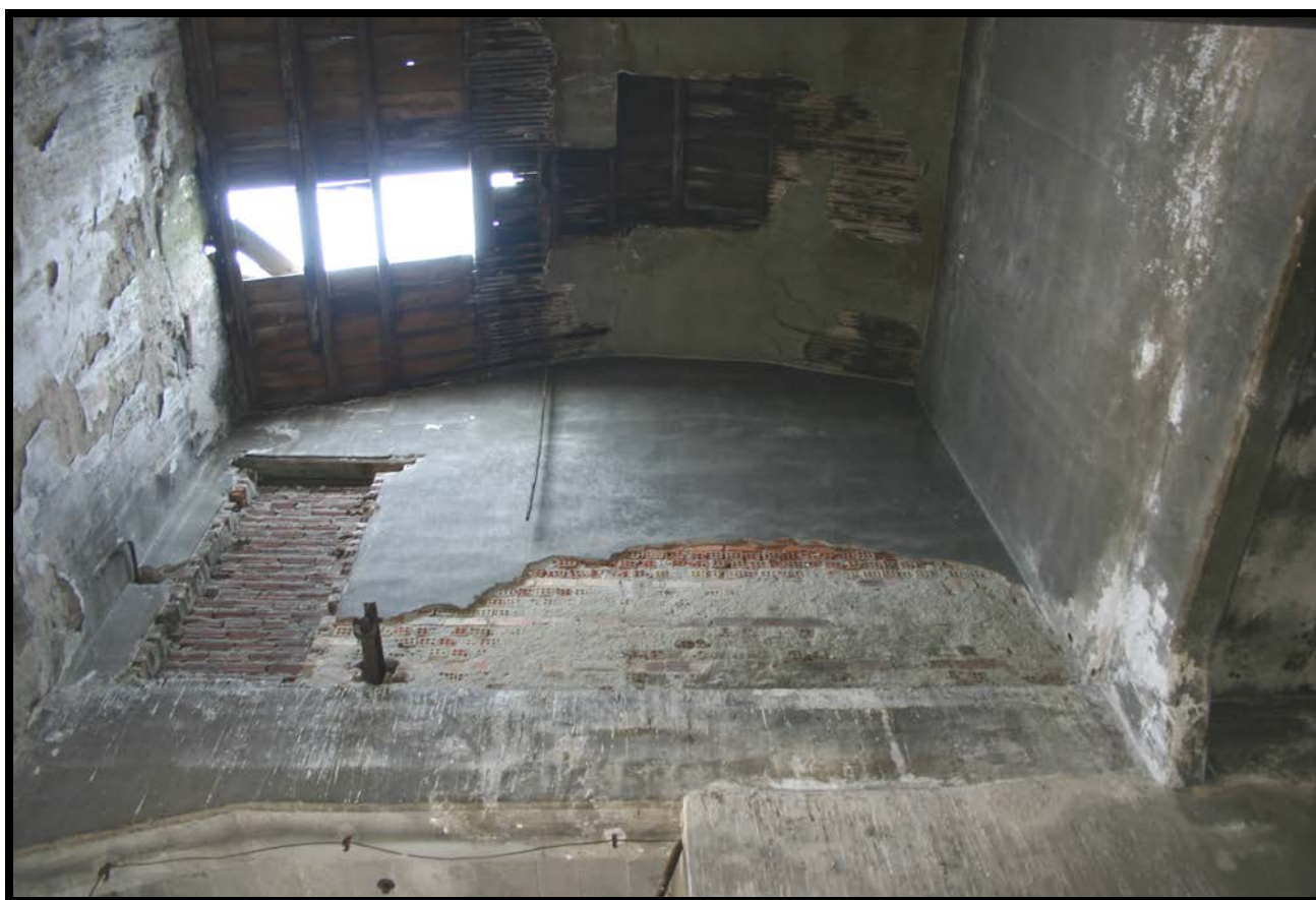
Εικόνα 17 : κακή κατάσταση δαπέδου
