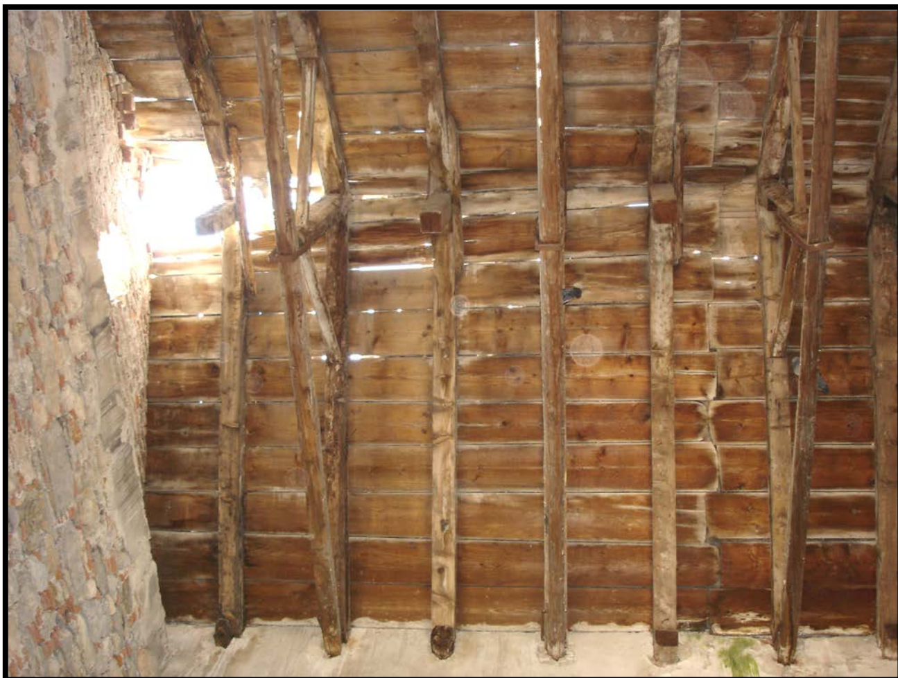
Εικόνα 13 : κακή κατάσταση στέγης
