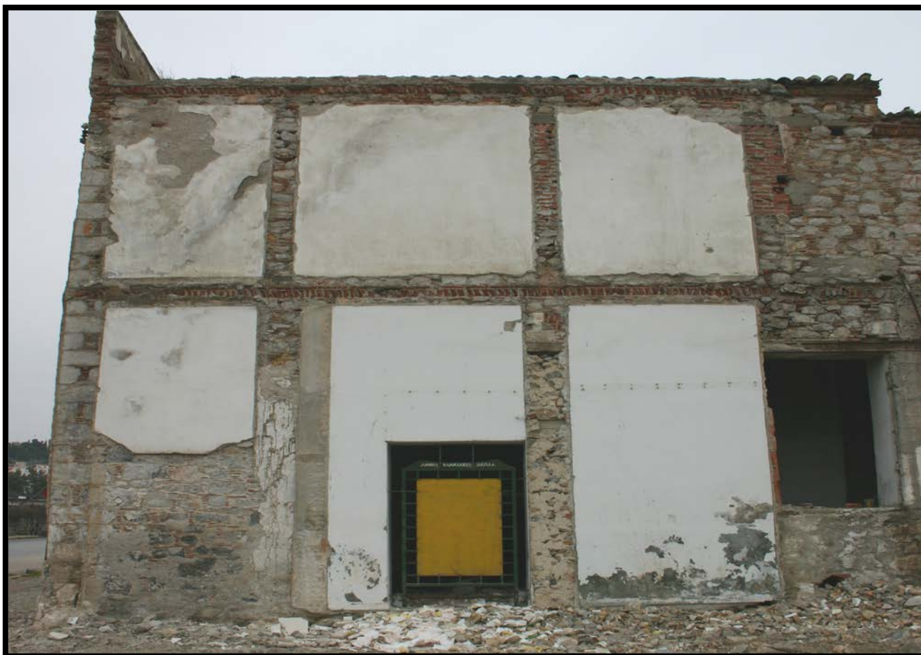
Εικόνα 11 : υποχώρηση σοβάδων στο κτίριο.
