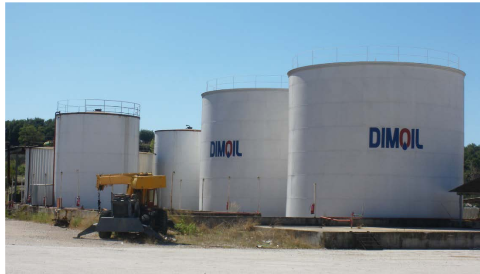
Εικόνα 7 Μονάδες Αποθήκευσης Πετρελαιοειδών
