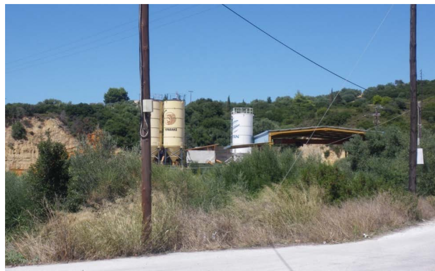
Εικόνα 11 Περιμετρικά του οικοπέδου η περίφραξη δεν καλύπτει τις προδιαγραφές που θέτονται, είτε λόγω πλήρους ανυπαρξίας φράχτη είτε λόγω ελλιπούς περίφραξης
