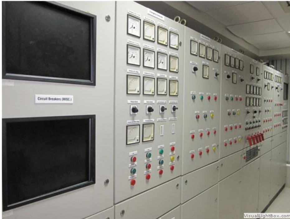
Σχήμα 6.1 Εικόνα από τους πίνακες ελέγχου που βρίσκονται στο δωμάτιο ελέγχου του πλοίου
