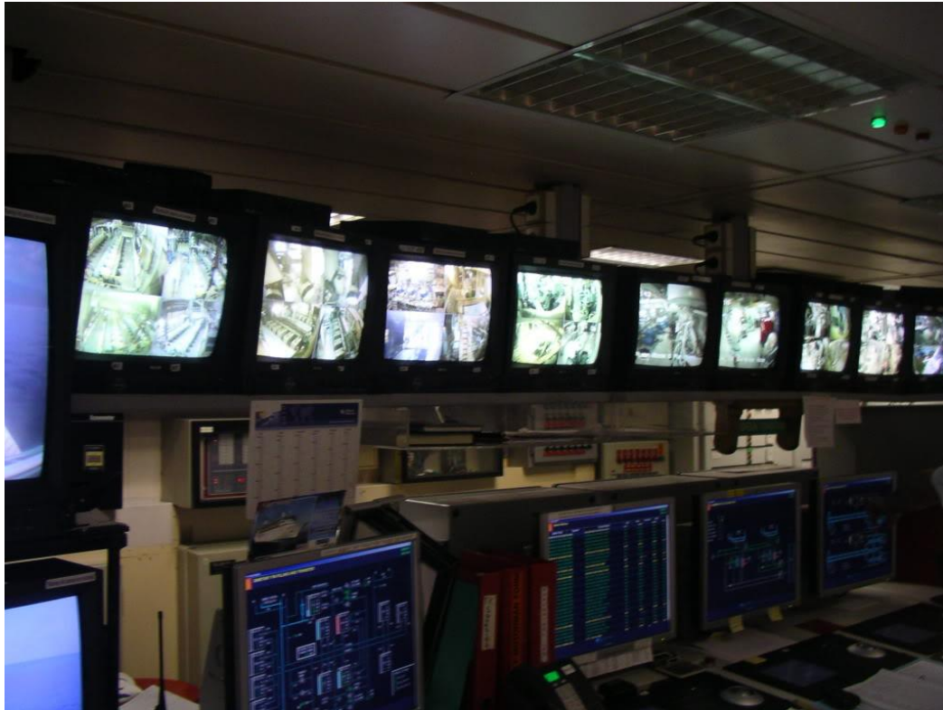
Σχήμα 6.5 Φωτογραφία δωματίου ελέγχου ενός πλοίου(engine control room)
