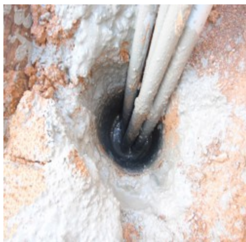
Εικόνα 5 - Φωτογραφία συστήματος με οριζόντιο γεωθερμικό εναλλάκτη
