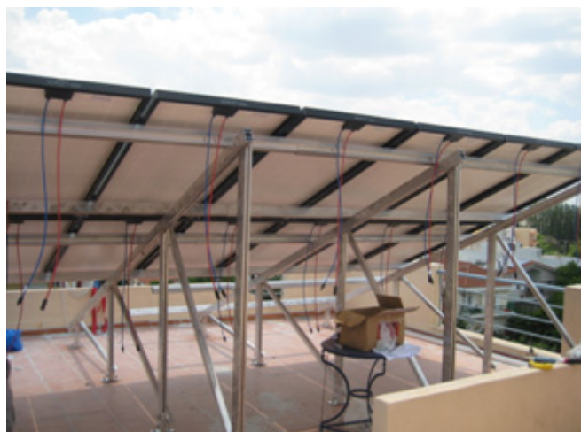
Εικόνα 24 – Καλωδίωση φωτοβολταϊκών πλαισίων
