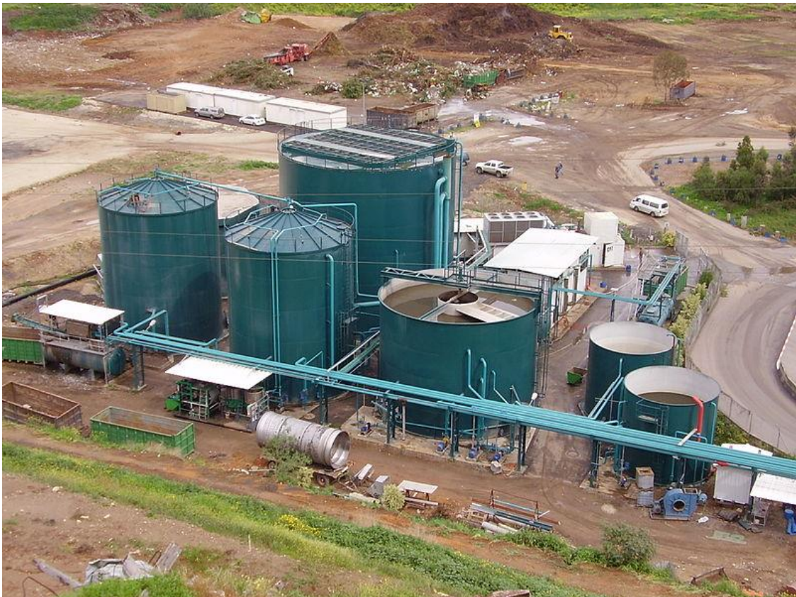
Εικόνα 3.4 Μονάδα αναερόβιας ΜΒΕ στο Τελ-Αβίβ, Ισραήλ
