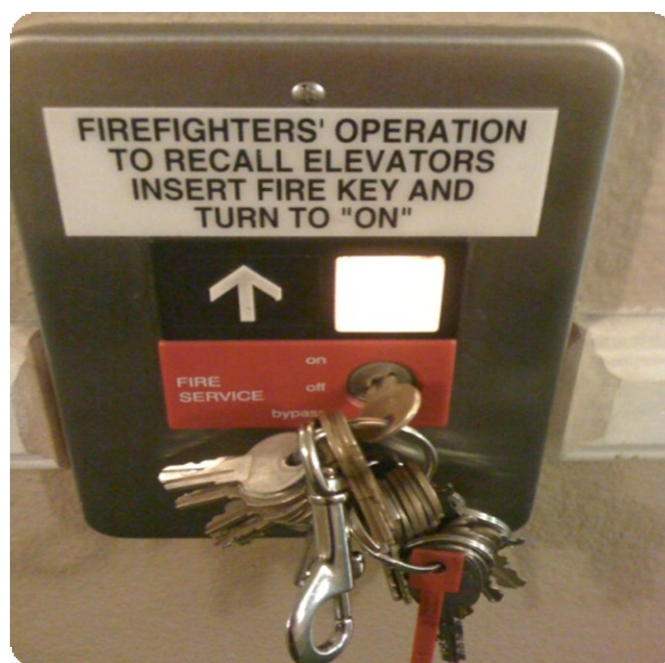
Εικόνα 6-2: Μπουτονιέρα ανάκλησης ανελκυστήρα με κλειδί, για περίπτωση φωτιάς.
