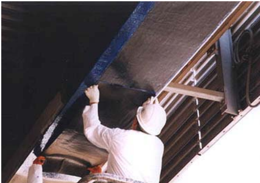
Εικόνα: Ενίσχυση δομικού μέλους με ελάσματα από σύνθετα υλικά από ινοπλισμένα πολυμερή.[ www.truedellcorp.com ]
