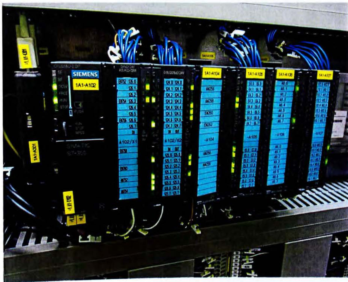
Ένα PLC S7 300 εγκατεστημένο σε πύνακα
