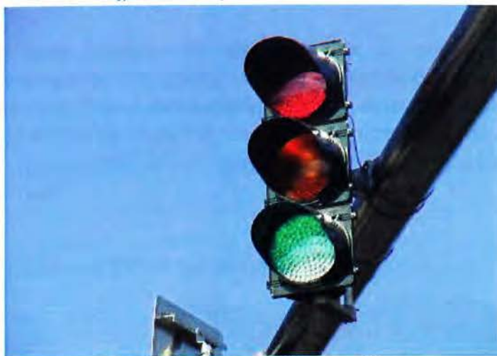
Εικ. 3.6 Φωτεινοί Σηματοδότες
