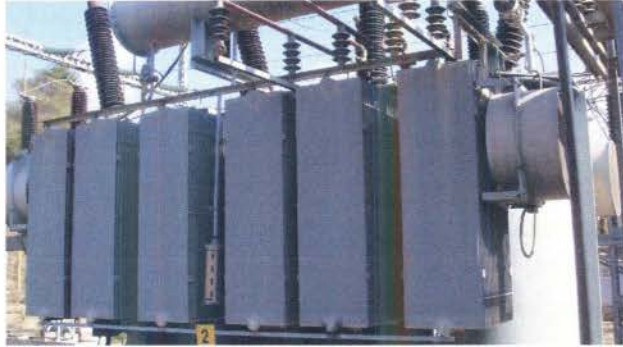
Σχήμα 3.2-1: Μετασχηματιστής ισχύος 150/20 kV – 20/25 MVA
