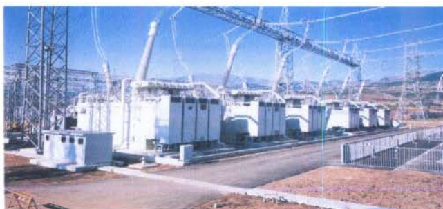
Σχήμα 2.2.1.5-3: Μονοφασικός αυτομετασχηματιστής των 1500 MVA
