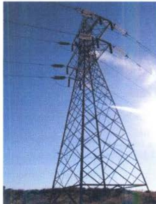
Σχήμα 2.1-1: Πυλώνας Υψηλών Τάσεων
