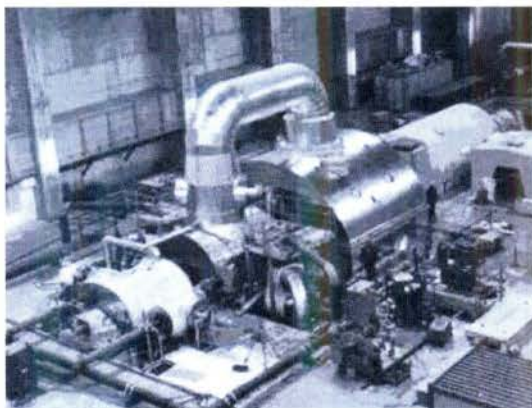
Σχήμα 2.2.1.4-1: Σύγχρονη γεννήτρια σε μονάδα συνδεδασμένου με ισχύ εξόδου από 300 έως 1200 MW-Ζεύγος ατμοστρόβιλου
