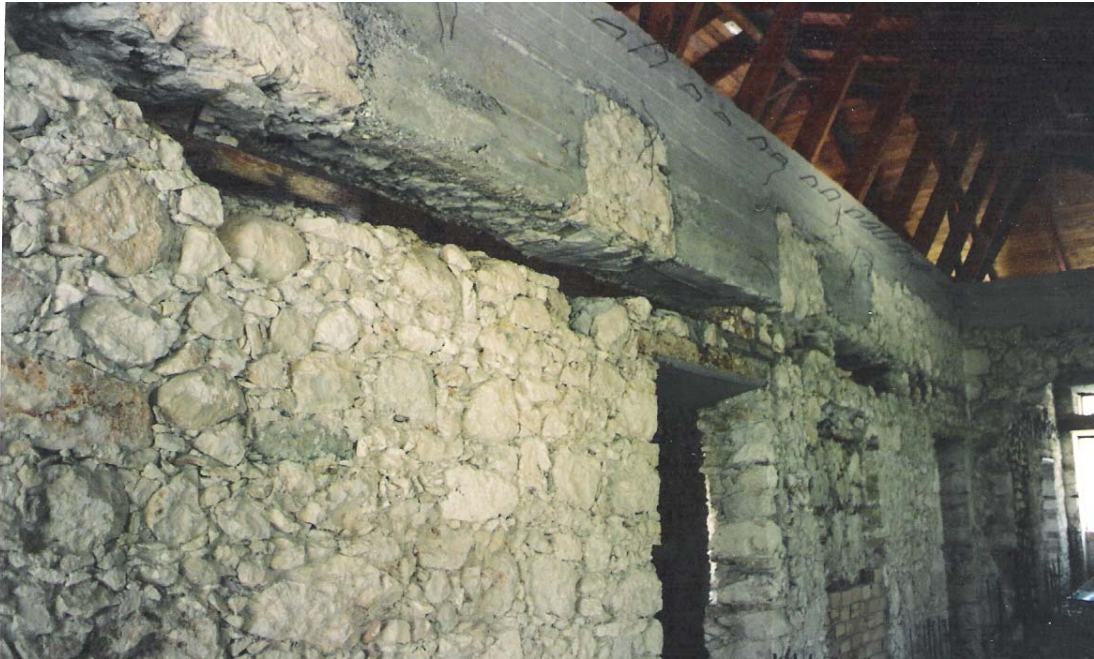
Εικόνα [33] Κατεστραμμένοι ελκυστήρες (ελκυστήρες-ξύλινα περβάζια) .
