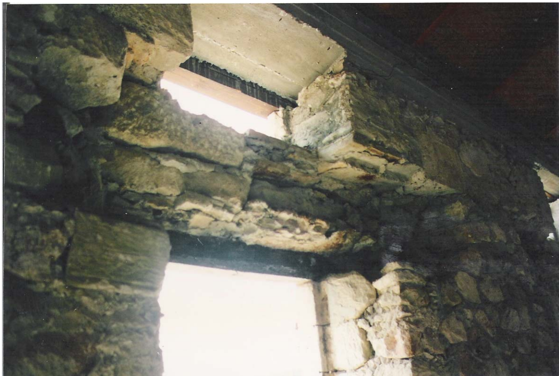
Εικόνα [38] Κατεστραμμένα εσωτερικά ανώφλια .
