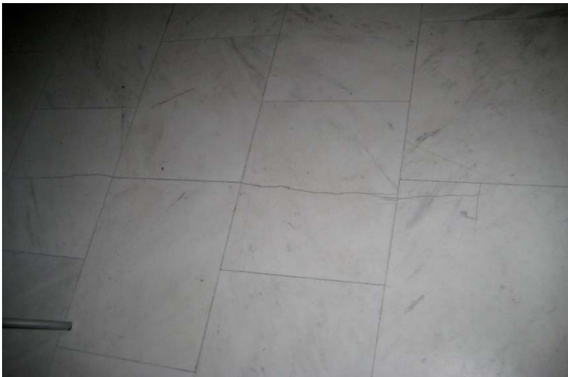
Εικόνα [47] Απεικόνιση ρωγμής μαρμάρινου πατώματος στον όροφο.
