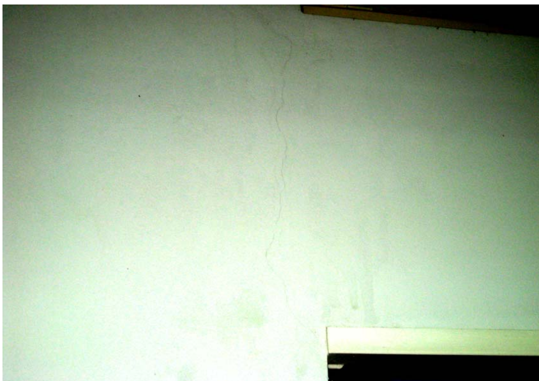
Εικόνα [46] Απεικόνιση παραδείγματος ρωγμής σε εσωτερικό τοίχο .
