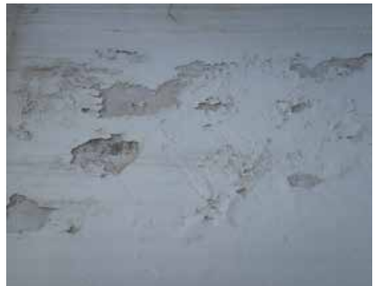
Εικ.26 Φθορές στον τοίχο.
