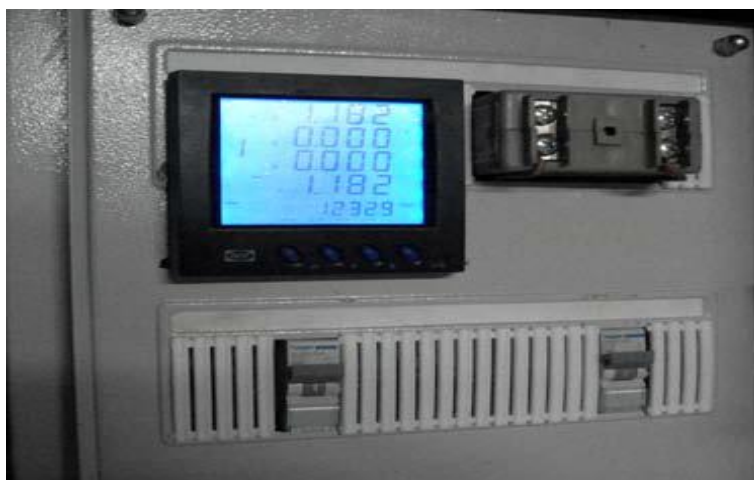
Εικόνα 3.1.ηλεκτρικός πίνακας φ/β πάρκου
