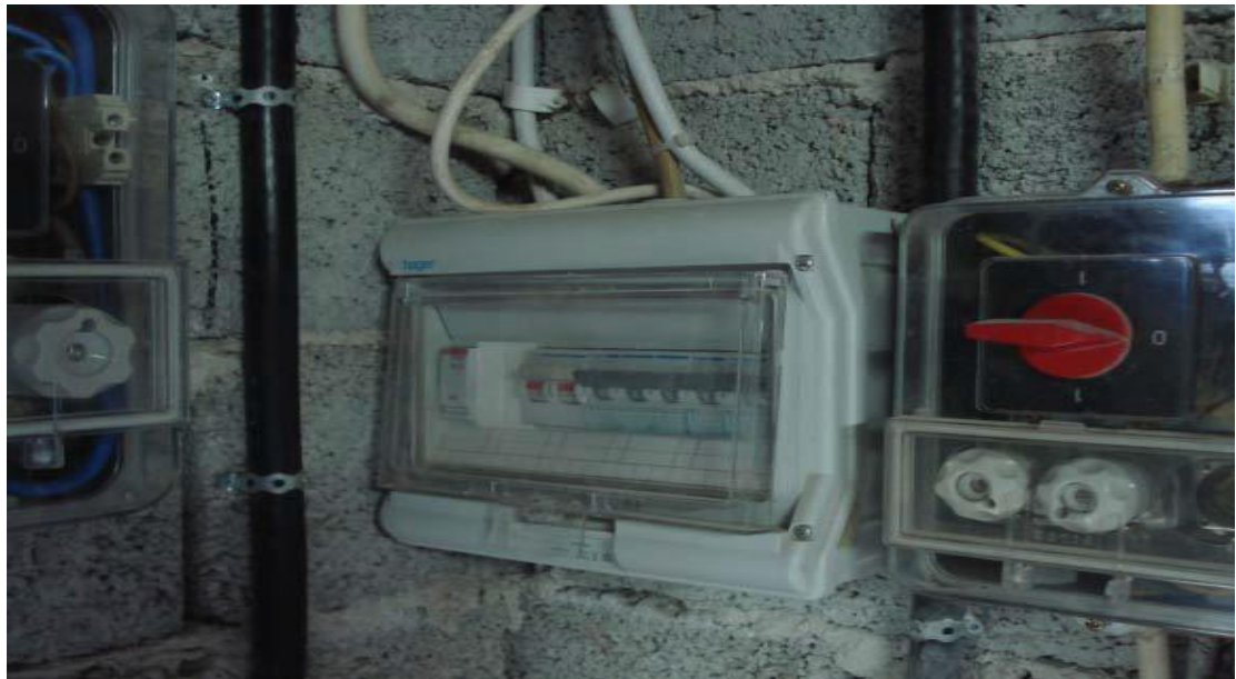
Εικόνα 3.2. Ηλεκτρικοί πίνακες φωτοβολταϊκής εγκατάστασης
