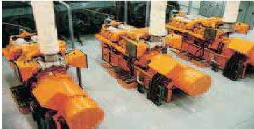
(Εγκατάσταση 3 Η/Ζ 1200 ΚVA στην Ολυμπιακή Αεροπορία)
