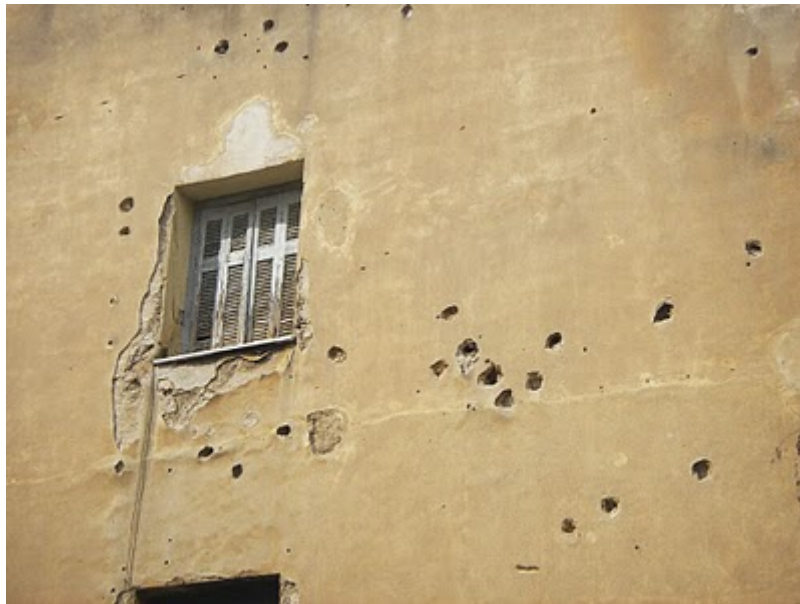
Σημάδια από τις σφαίρες που φώλιασαν στους τοίχους τον Δεκέμβριο του '44.
