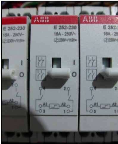
Εικόνα 41. Ρελέ καστανίας τοποθετημένα στον ηλεκτρολογικό πίνακα
