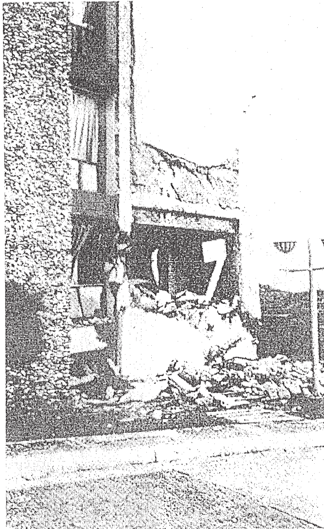
Σχήμα 1.6. Αστοχία της κατώτερης στάθμης πλαισίου οπλισμένου σκυροδέματος με τοιχοπήρωση.(σεισμός Φιλιππίνων 1990.)
