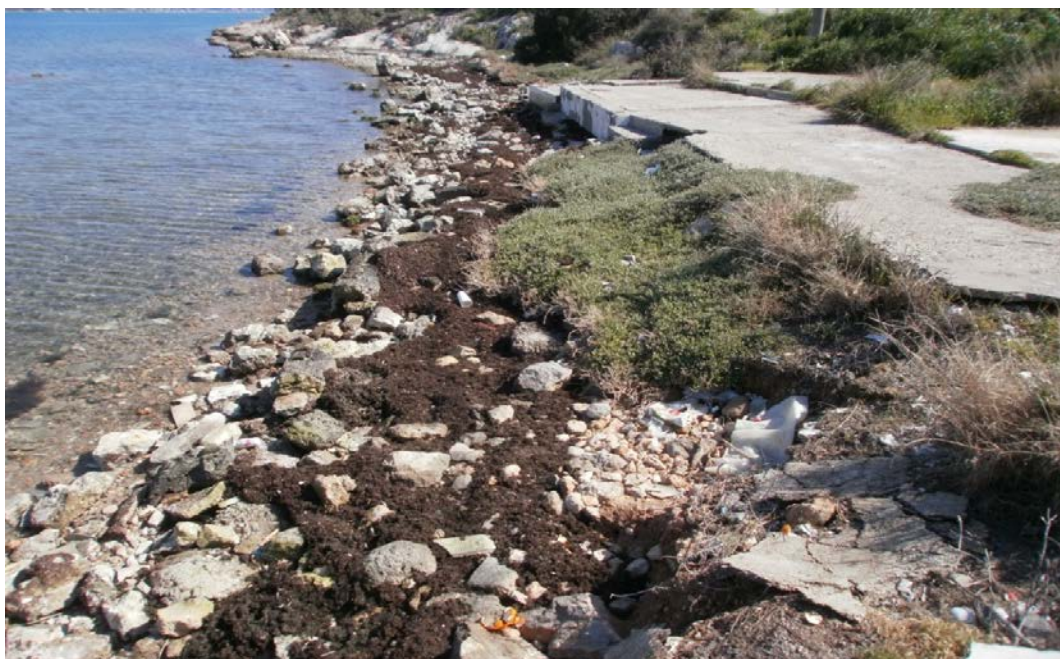
Εικόνα 65 Τμήμα ασφάλτου με σαθρό υπόστρωμα το οποίο κατέρρευσε
