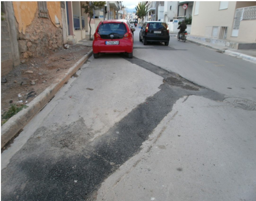
Εικόνα 108 Μπάλωμα σε συνοικιακό δρόμο
