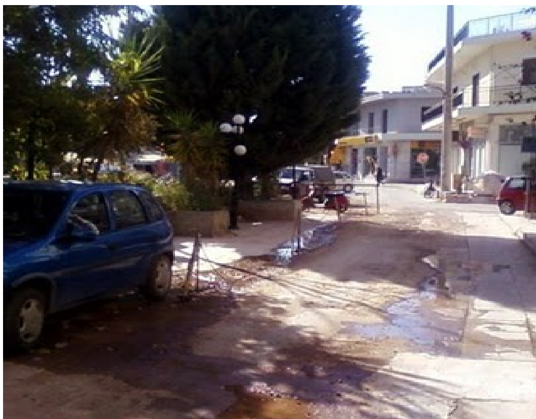
Εικόνα 103 Η κακή συντήρηση του πλακόστρωτου έχει μετατρέψει το πεζόδρομο σε λασπώδη δρόμο, ο οποίος δεν ενδείκνυται για περιπάτους
