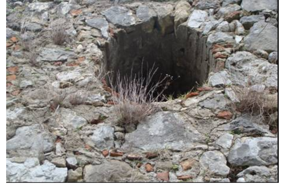
Κυκλικό άνοιγμα στη δυτική πλευρά του πύργου.
