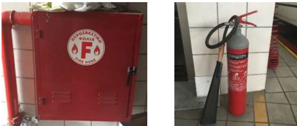
Εικόνα 17. Πυροσβεστική Φωλιά και Πυροσβεστήρας
