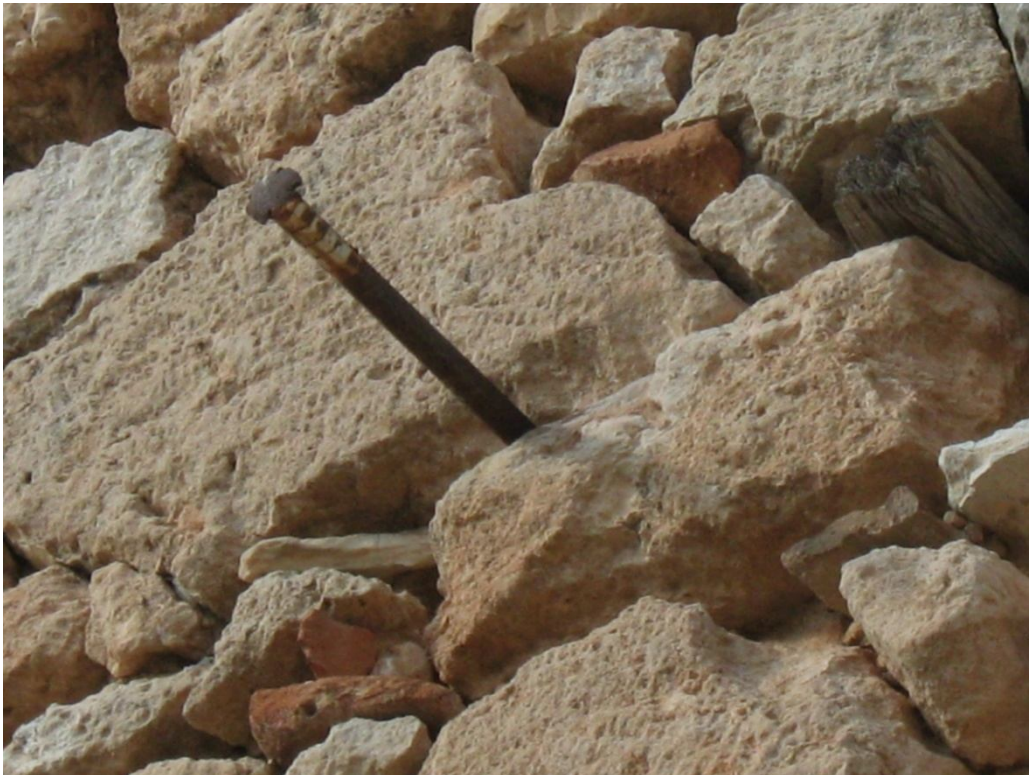
Εικόνα 61 : Μεταλλικό στοιχείο που βρίσκεται στο κενό μεταξύ των λίθων, φαίνεται επίσης και κομμάτι από ξύλο που είναι ενσωματωμένο στην κατασκευή.
