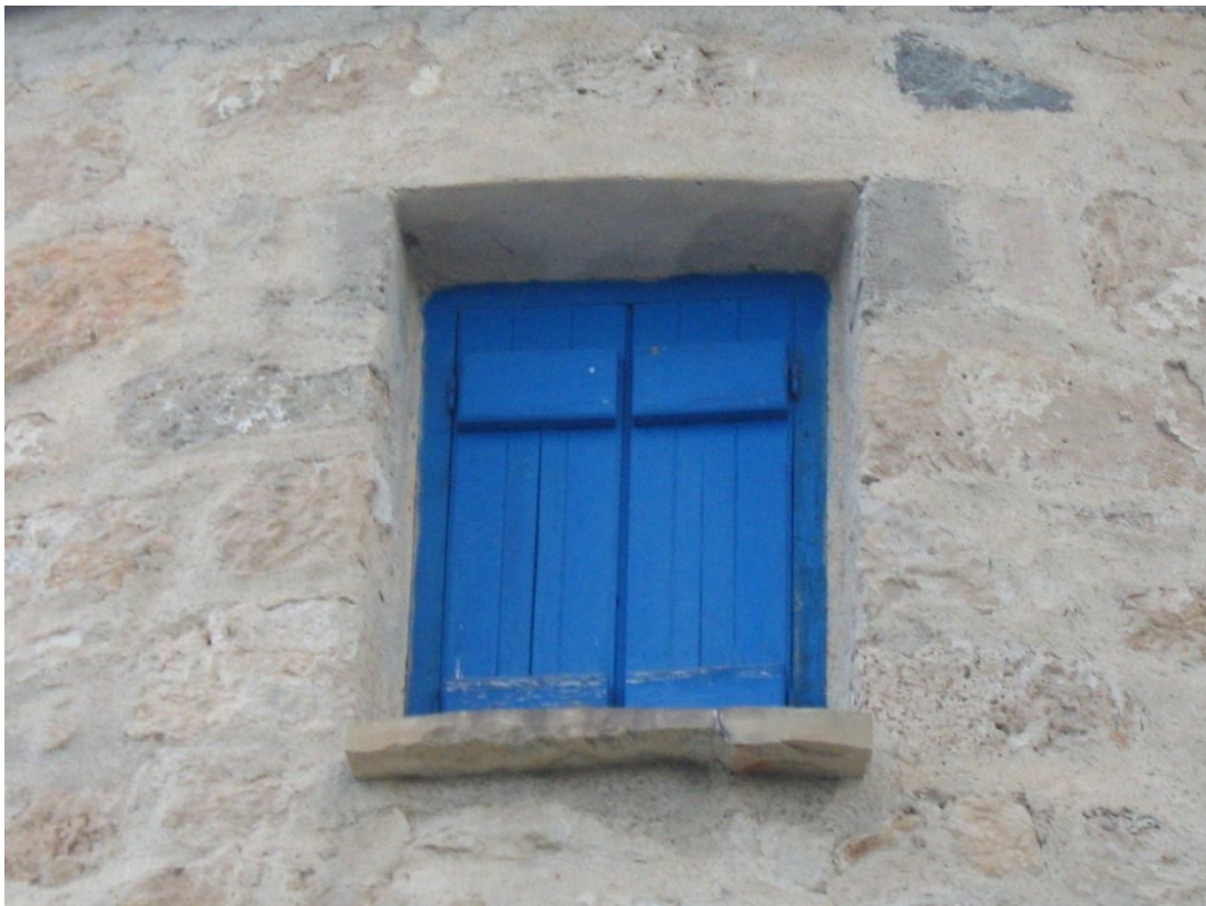
Εικόνα 40 : Άνοιγμα στο πάνω μέρος της βόρειο – ανατολικής πλευράς της βίγλας
