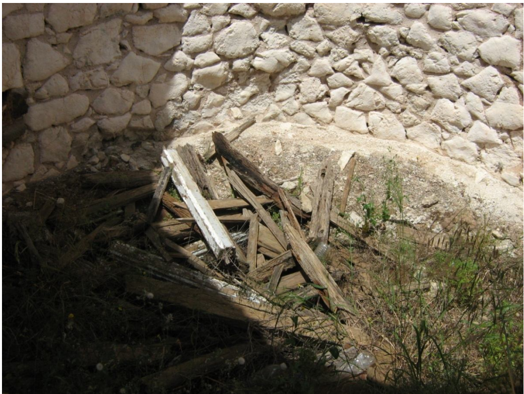
Εικόνα 14 : Εσωτερική άποψη από την Βίγλα, όπου παρατηρούμε συντρίμμια πιθανότατα από την κατεστραμμένη στέγη της
