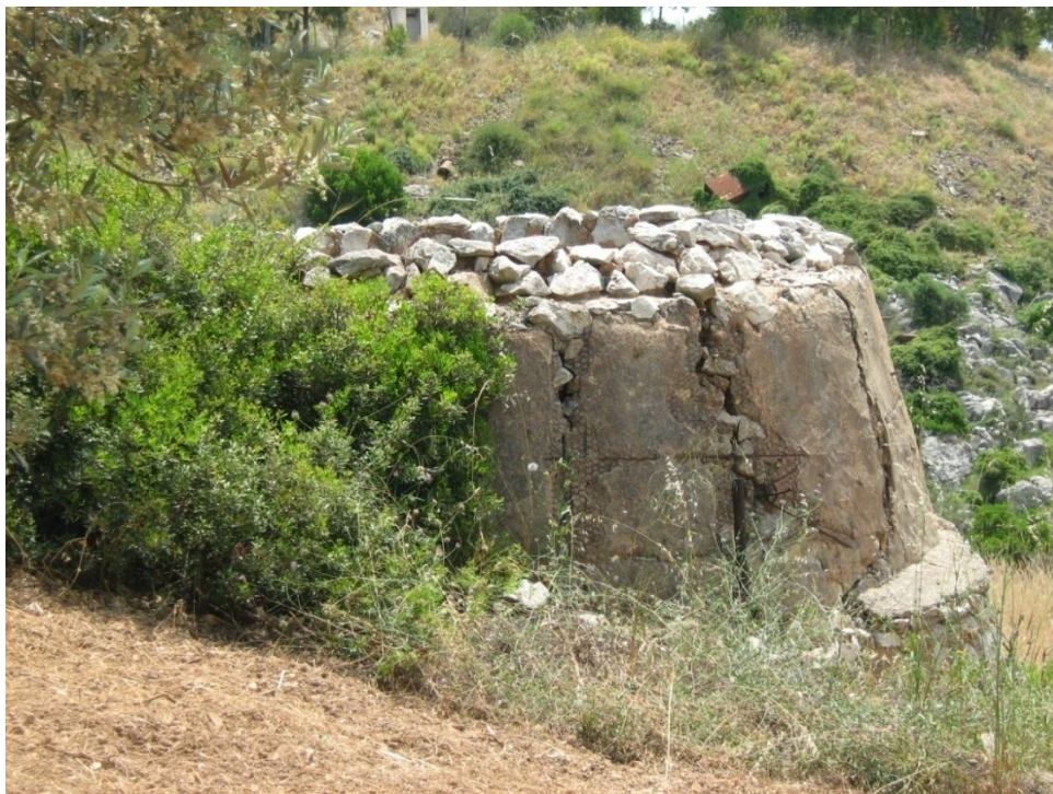
Εικόνα 18 : Η βίγλα όπως φαίνεται από την αριστερή της όψη, παρατηρούμε την ασβεστοκονία, καθώς και σίδερα – πλέγμα που είχε τοποθετηθεί αργότερα για την ενίσχυση της
