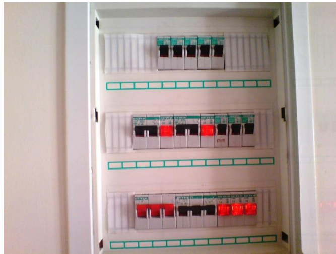
Εικόνα 2.1 – Οικιακός ηλεκτρικός πίνακας ελαχίστων απαιτήσεων
