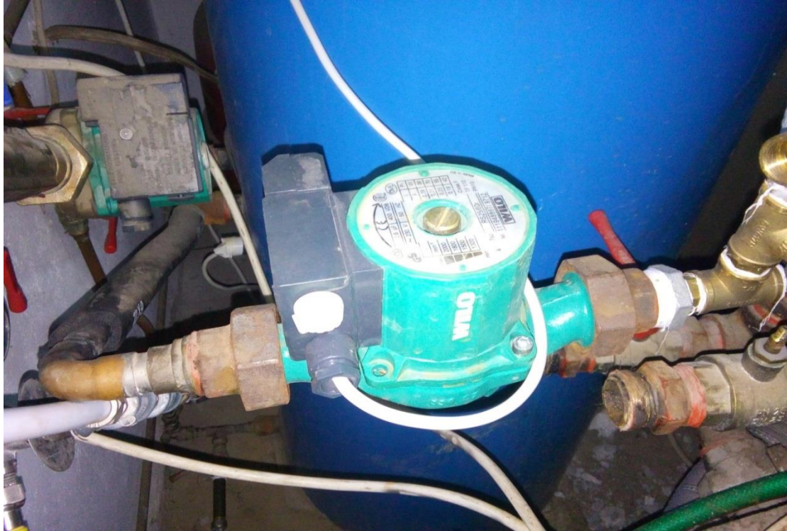
Σχήμα 10.7 Ο κυκλοφορητής τοποθετούμενος στη είσοδο του ζεστού του δοχείου.
