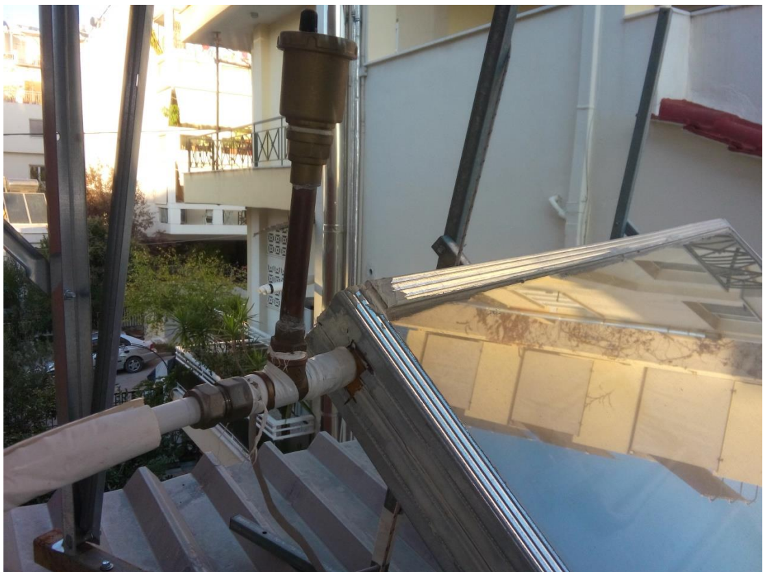
Σχήμα 10.12 Ο αυτόματος εξαέρωσης και το σημείο τοποθέτησης του αισθητήρα 18b20.
