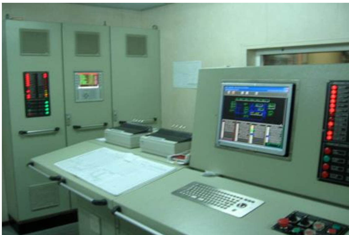
Εικόνα 6. Δωμάτιο ελέγχου - PLC πλοίων
