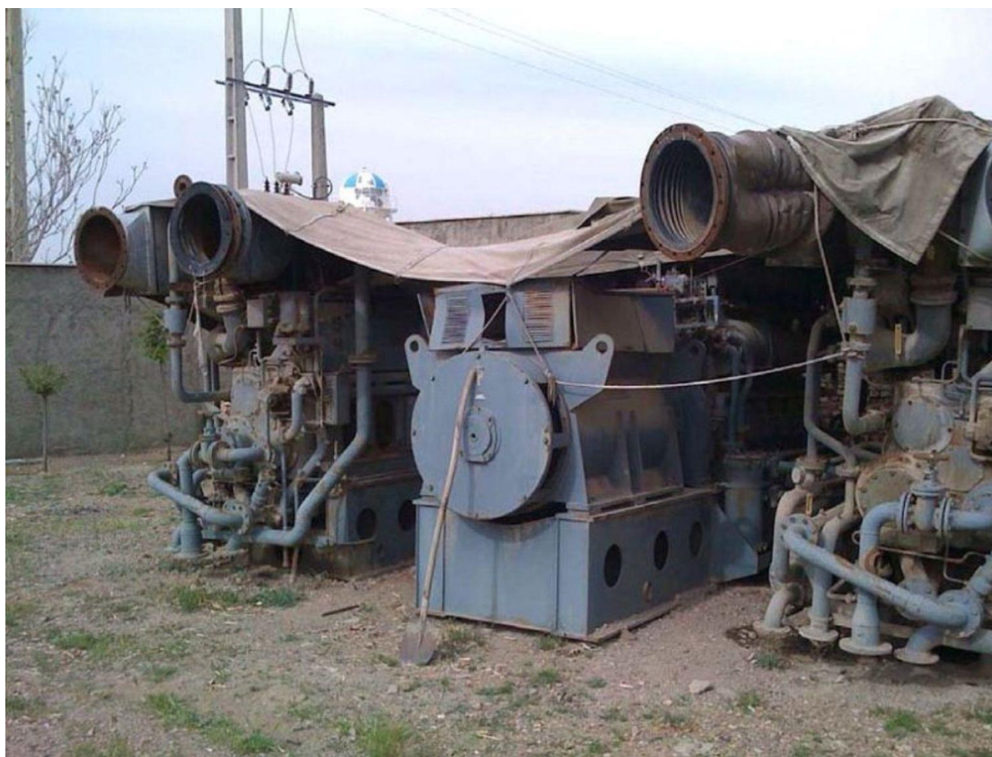
Εικόνα 15. Τμήματα ηλεκτρομηχανολογικού εξοπλισμού κατά την ανακύκλωση
