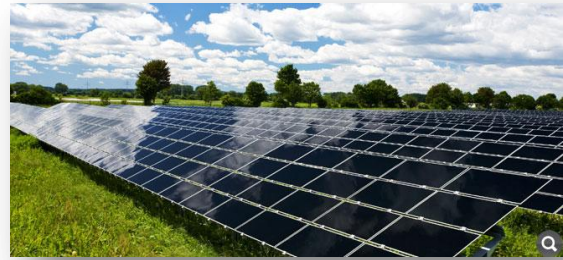
Φωτοβολταϊκό ηλιακό σύστημα σε αγρόκτημα
