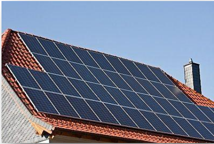
Φωτοβολταϊκό ηλιακό σύστημα σε στέγη
