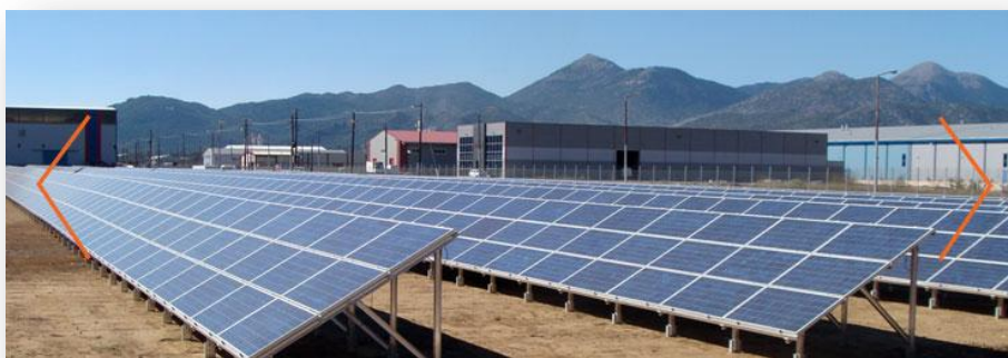
Φωτοβολταϊκή συστοιχία με σταθερές βάσεις
