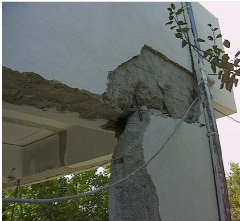
Σχ. 2.3 Αστοχία κόμβου λόγω απουσίας Ικανοτικού Σχεδιασμού. (Λίτσος 2012)
