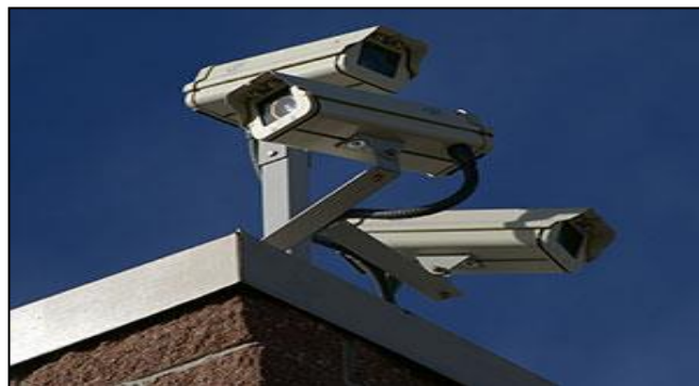
Εικόνα 2.12 – Κάμερες παρακολούθησης με έλεγχο κατεύθυνσης
