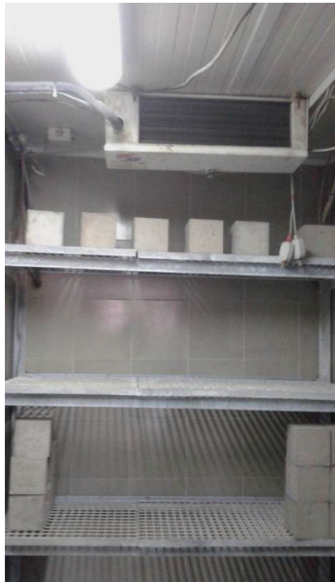
Εικόνα 6.6 Ειδικός χώρος φύλαξης θερμοκρασίας 19°C και υγρασίας 90%
