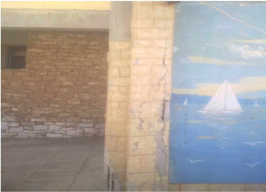
Εικόνα 3.1 Αστοχία υποστρώματος λόγω σεισμού [5]
