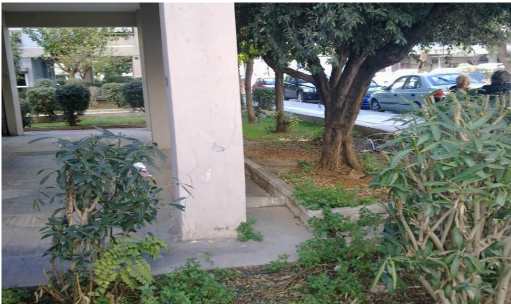
Εικόνα 3.2 Αστοχία υποστρώματος λόγω φυσικοχημικών αντιδράσεων – περιβάλλον [5]
