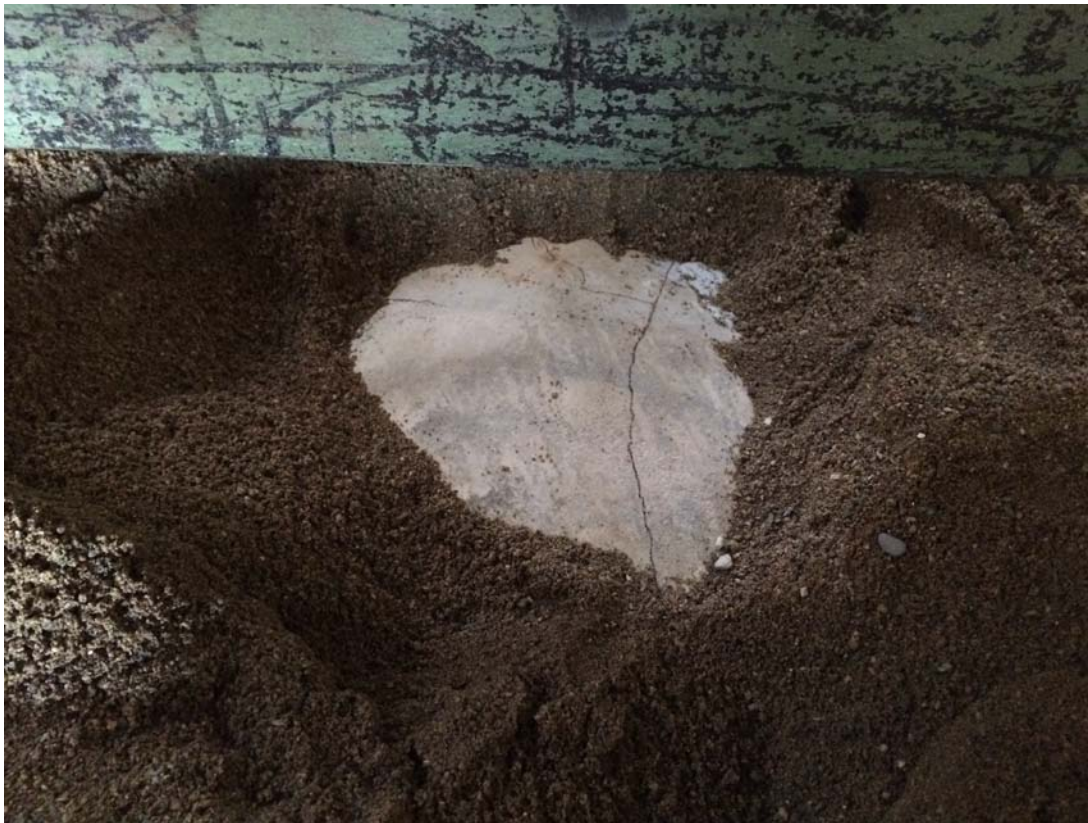
Εικόνα 63.Αδειασμα άμμου και εμφάνιση των πρώτων ρωγμών
