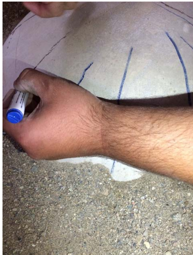
Εικόνα 64.Εμφάνιση και σημάδεμα των ρωγμών του γ'γ άξονα(όρθιες ρωγμές)
