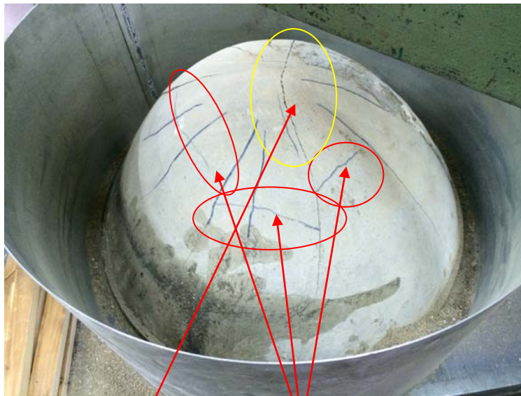
Εικόνα 66.Εμφάνιση και σημάδεμα των ρωγμών του x'x άξονα(οριζόντιες ρωγμές)
