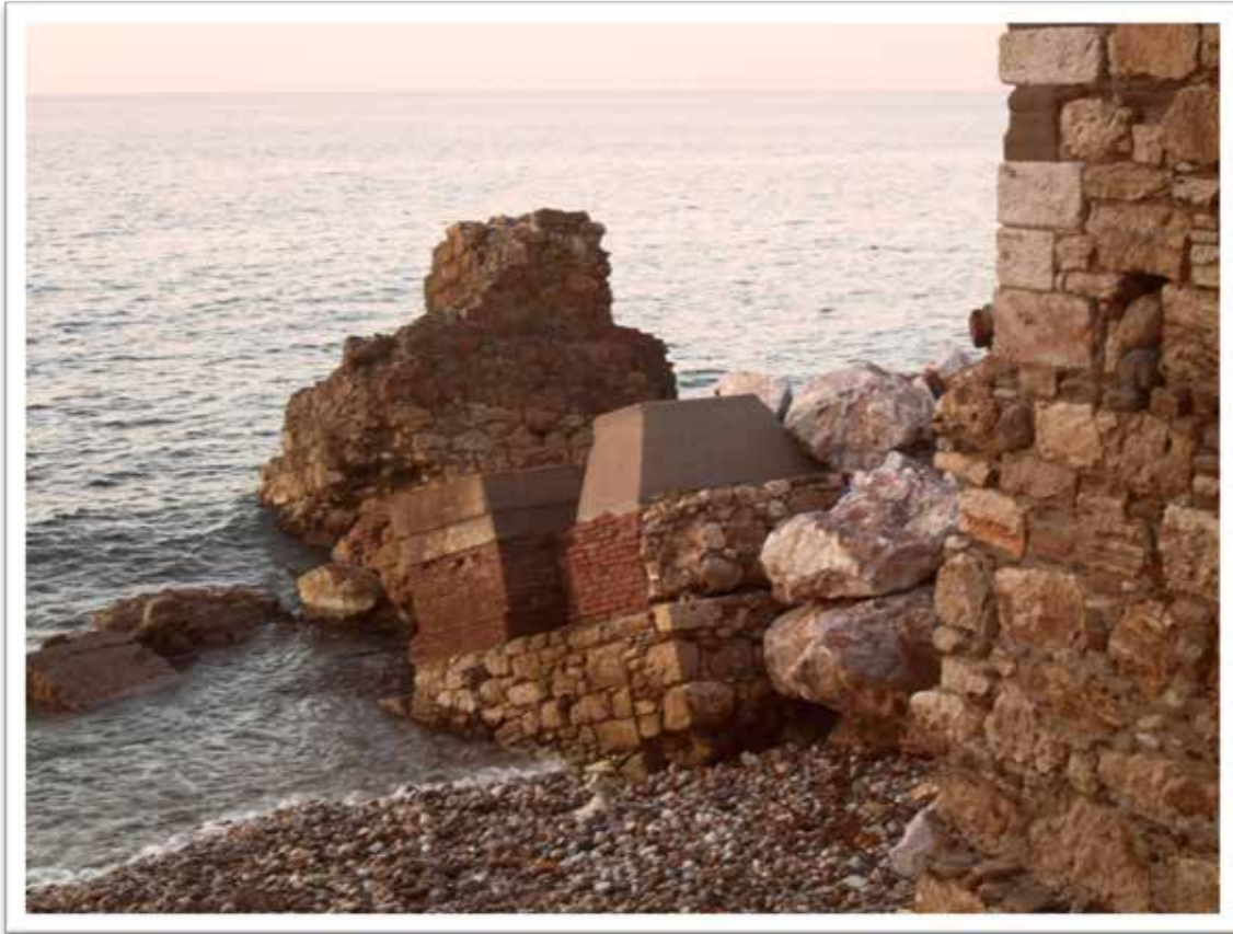
Εικόνα 30: Υπάρχουσα κατάσταση(Το φουγάρο καθώς και κομμάτια τοίχου βρίσκονται πλέον μέσα στην θάλασσα)
