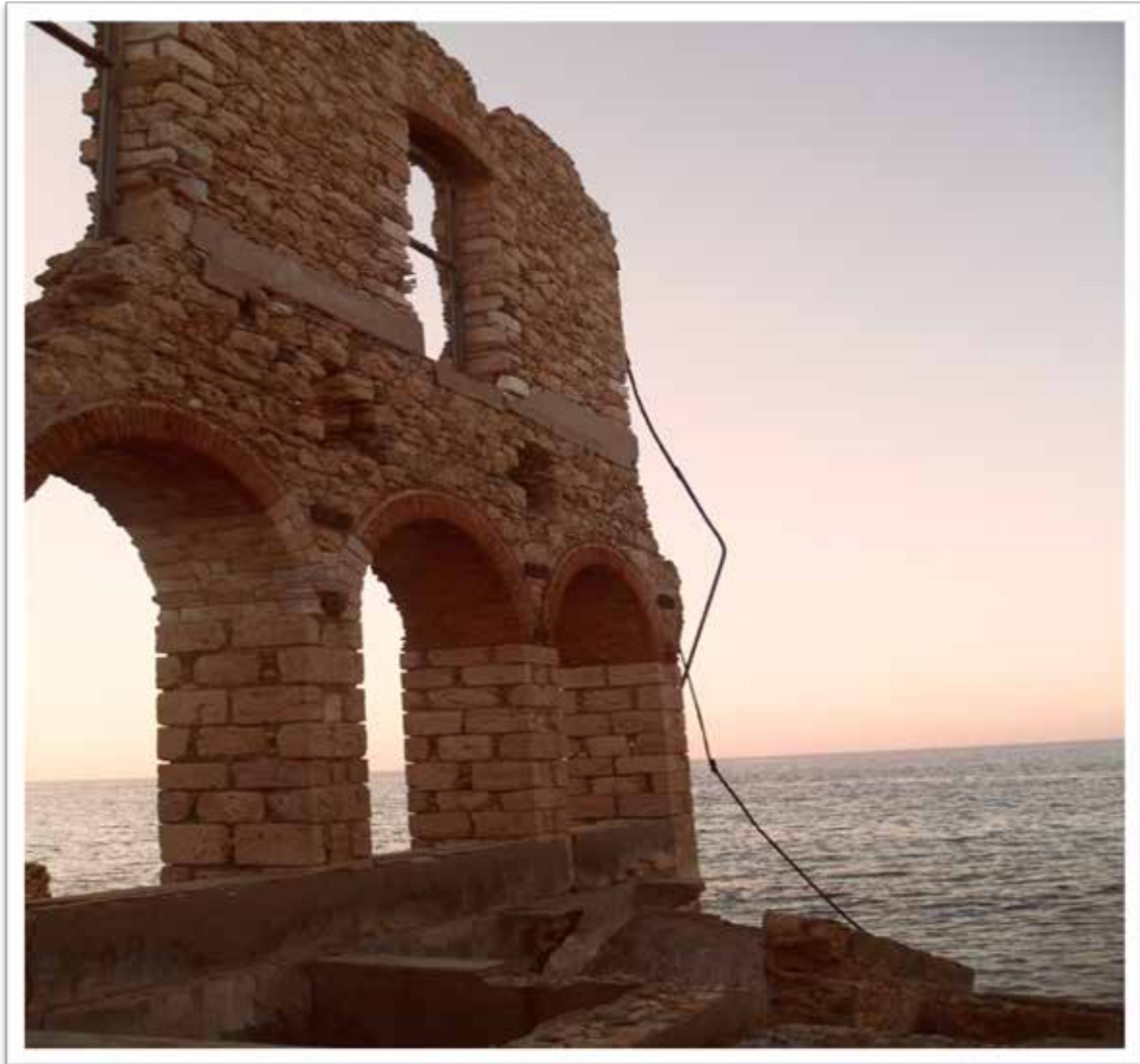
Εικόνα 29: Υπάρχουσα κατάσταση(Ο τοίχος από την μεριά της θάλασσας δεν υπάρχει πλέον)
