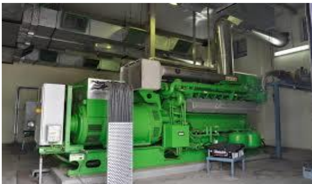
Εικόνα 2.16-1 :Μονάδα συμπαραγωγής φτωχού μείγματος
