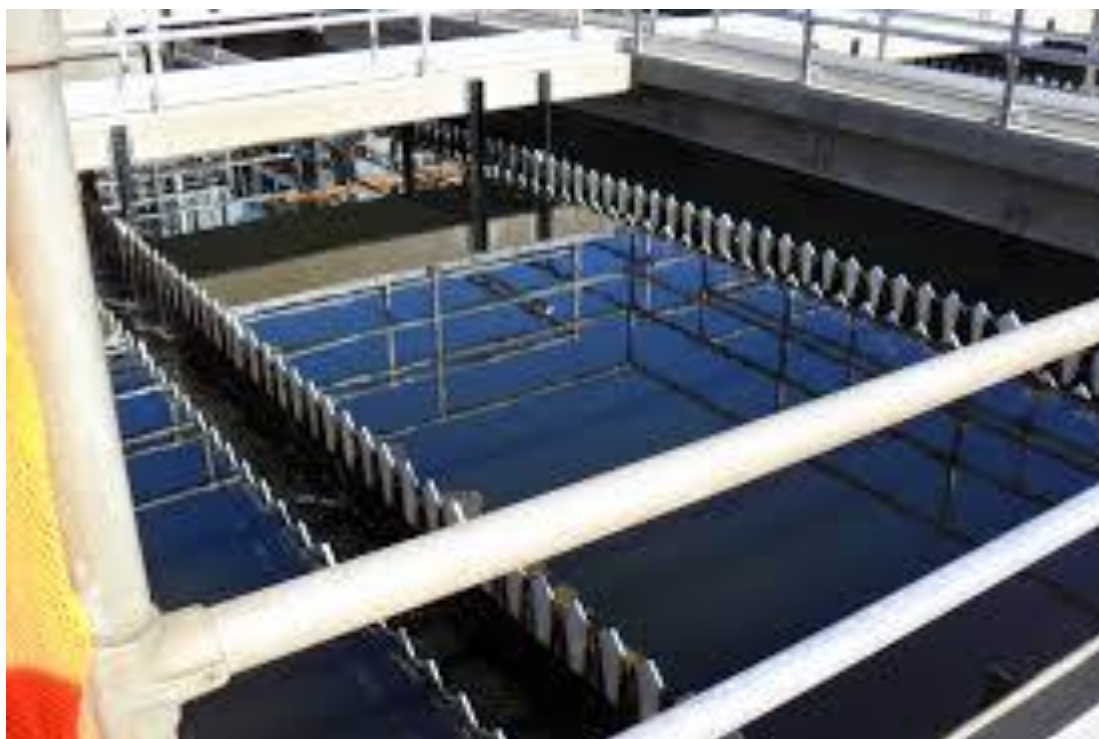
Εικόνα 2.7-1 : Δεξαμενή τελικής καθίζησης.
