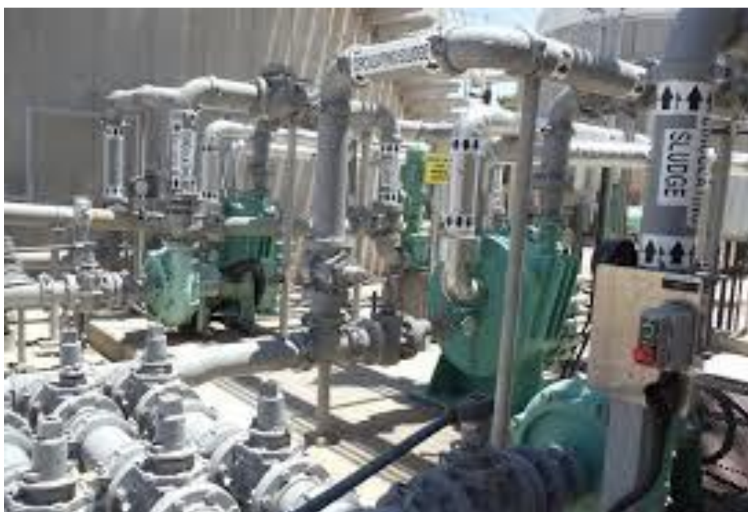
Εικόνα 2.12-2 : Αντλιοστάσιο ανακυκλοφορίας – θέρμανσης λάσπης.
