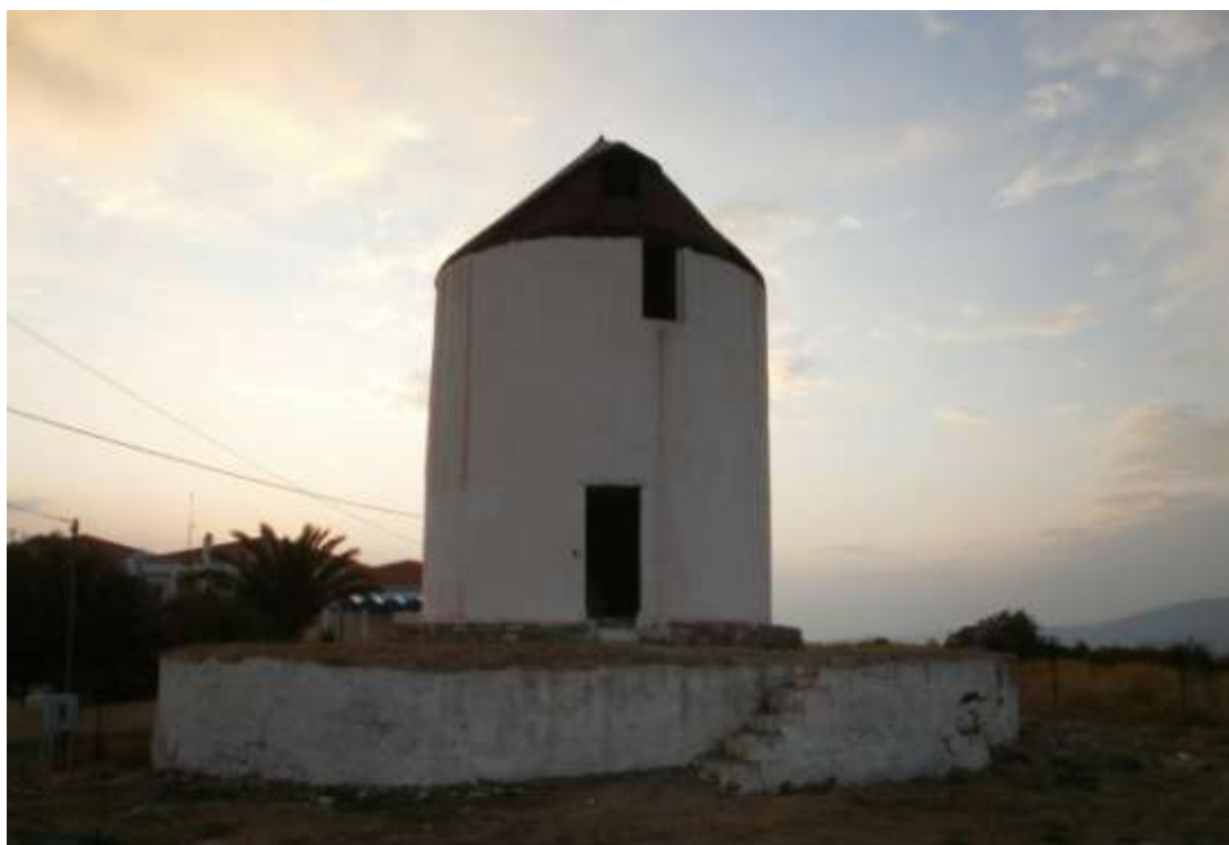
Εικόνα 34 Λόγω της ιδιαιτερότητας του Κρανιδίου, οι πυργόμυλοι θεμελιώνονται σε βραχώδες έδαφος, κεκλιμένο ή οριζόντιο. Συνήθως διαθέτουν εξωτερικό περιφερειακό πέδιλο, όπως ο ανεμόμυλος του Ντουνέτα
