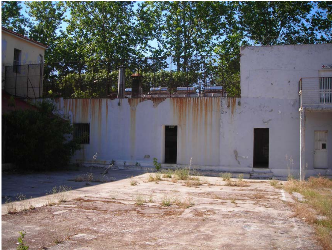
Εικόνα 1.17: Οι χώροι υγιεινής
