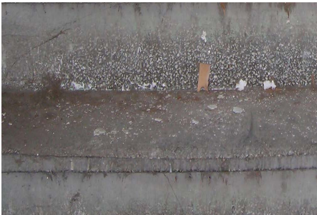
Εικόνα 2.4: Η οξείδωση που παρατηρείται στη σκάλα του κτιρίου Α
