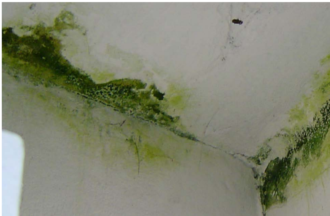
Εικόνα 2.3: Η μούχλα που παρατηρείται σε ένα από τα ταβάνια του κτιρίου Β
