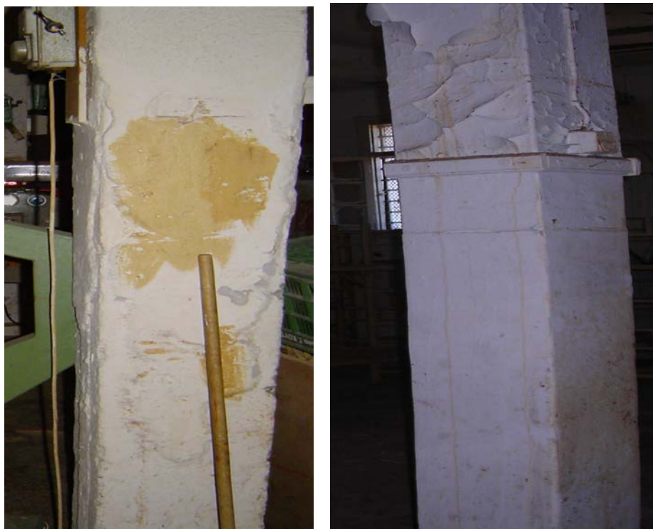
Εικόνες 2.8,2.9: Φθορές σε υποστυλώματα του κτιρίου Α
