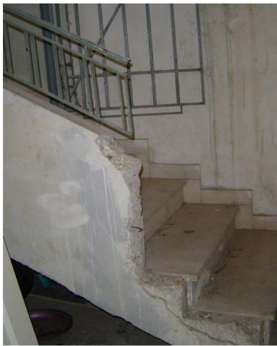
Εικόνα 2.5: Η αποκόλληση του σκυροδέματος στη σκάλα του κτιρίου Β
