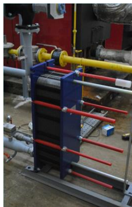
Εικόνα 6: Εναλλάκτης θερμού νερού στην ΤΥ
