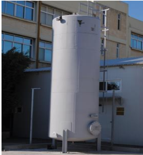
Εικόνα 4: Δεξαμενή αποθήκευσης θερμού νερού
