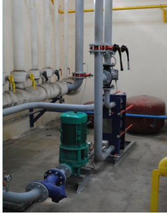
Εικόνα 7: Εναλλάκτης θερμού νερού στην ΣΔΟ
