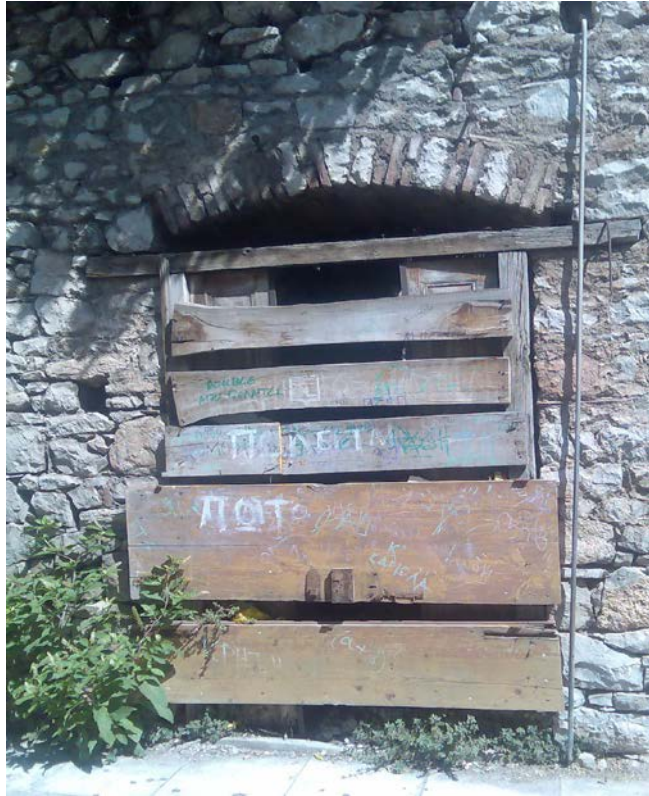
ΠΙΣΩ ΠΟΡΤΑ ΚΤΙΡΙΟΥ ΠΡΟΣ ΕΠΙΣΚΕΥΗ
